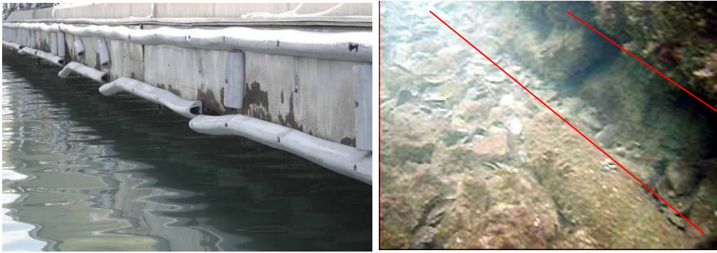
Fig. 12: A l'esquerra, oxidació i trencament de les proteccions del moll per a amarraments temporals en front de Capitania i proveïment de combustible. Això és degut al seu ús intensiu. A la dreta, descalç de formigó d'aproximadament 3x0,3x0,25 m a l'amarratge 5013.
