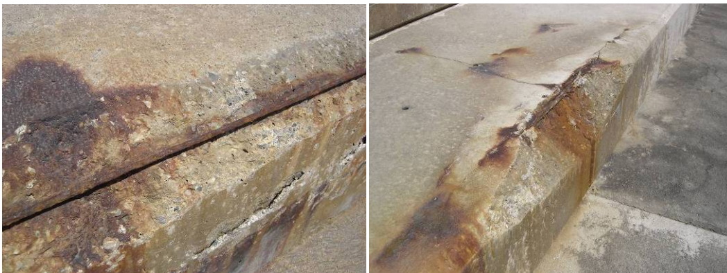
Fig. 8: Taques generalitzades d'òxid i falta de formigó que deixa a la vista parcialment les armadures d'acer. Les taques són una clara senyal que l'armadura s'està oxidant, per tant, està augmentant el seu diàmetre i acabarà per trencar el formigó com en la resta de casos.
