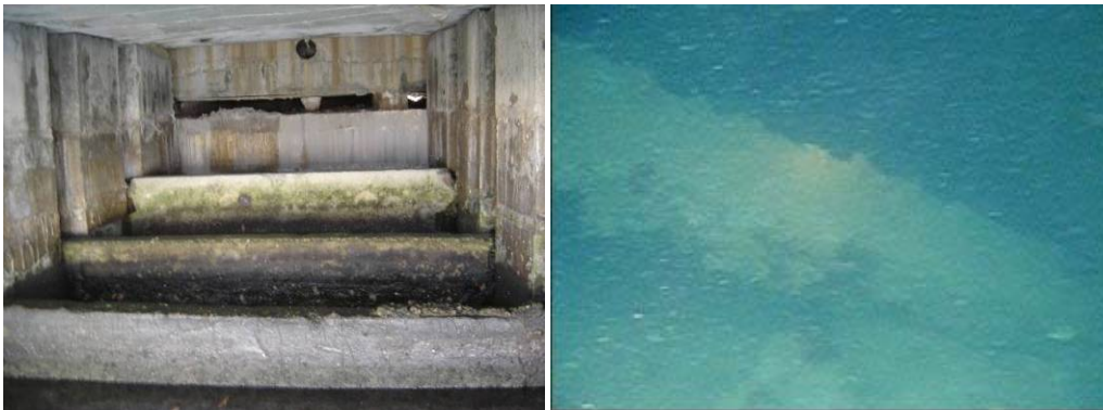
Fig. 13: El moll de recer està format per cinc planxes verticals que actuen com a trencaones, però amb el temps alguns dels suports s'han trencat i els podem trobar al fons. Però aquest tipus de lesió no té conseqüències estructurals greus sobre el moll.
