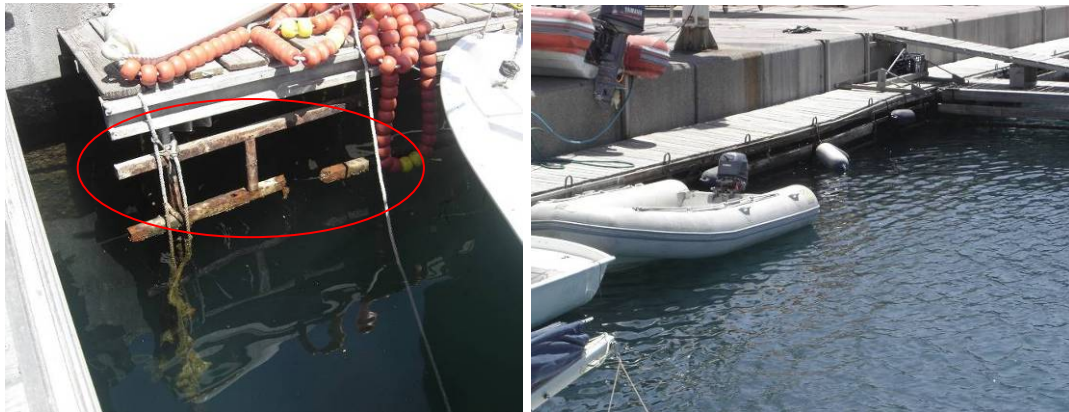
Fig. 10: Els pantalans flotants presenten clars símptomes d'oxidació i trencaments. Aquests no estan totalment horitzontals degut a un fort deteriorament de l'estructura.
