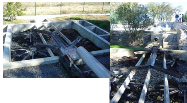
Fotografía 15. Filtro percolador de las EDARs de Bicos red A y red B (figuras superiores, derecha y izquierda respectivamente).
