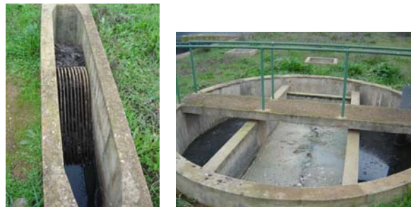
Fotografía 9. Obra de entrada y Tanque Imhoff de Vale Ferro (a la izquierda y derecha respectivamente).
