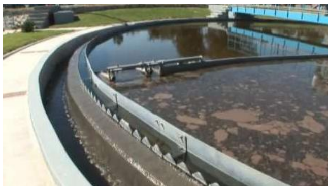
Ilustración 18 Fuente: Fotos tomadas de un video de la planta de tratamiento de aguas residuales en Jalisco, México.
