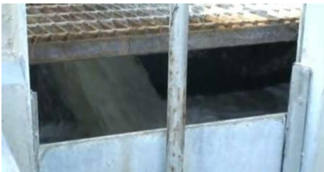
Ilustración 15 - Desbaste Fuente: Fotos tomadas de un video de la planta de tratamiento de aguas residuales en Jalisco, México.
