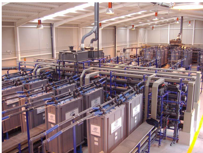
Ilustración 13 - Planta de servicio donde se utiliza la electrodiálisis reversible como método de desalación Fuente: Grupo Aguas Valencia
