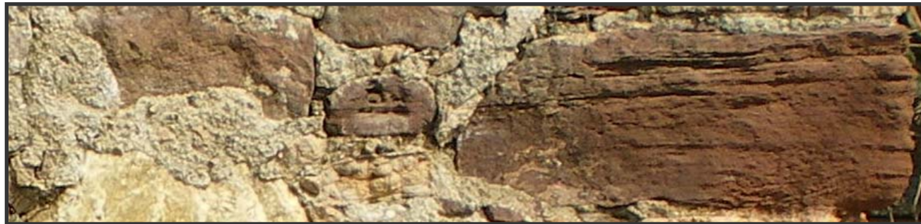
IMAGEN 30. IMAGEN DE PIEDRA ARENISCA ROJA DEL MURO DEL MOLINO COLOCADA CORRECTAMENTE, CON LA ESTRUCTURA LAMINAR PERPENDICULAR AL ESFUERZO DE COMPRESIÓN.
