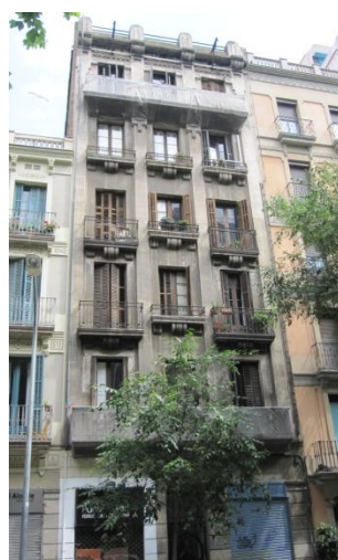
Figura 4.29: Edifici en mal estat de conservació; diversos desprendiments de les lloses dels balcons. C/ Concell de Cent, 258. Font: Elaboració pròpia.
