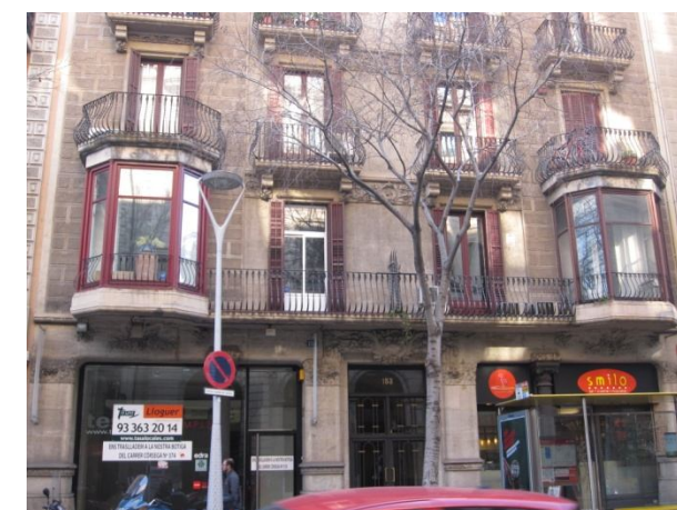
Figura 4.28: Substitució de la fusteria d'una de les finestres de primera planta trencant amb la coherència de color (de granat a blanc) de la resta de les fusteries. C/ Pau Claris 153. Font: Elaboració pròpia.
