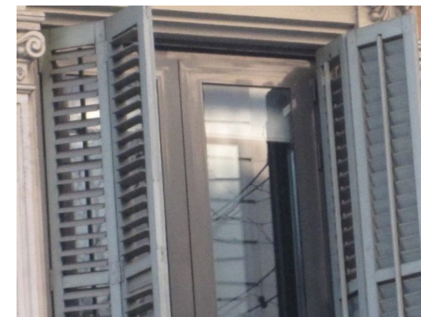
Figura 4.26: Detall de fusteria substituïda conservant les lamelles de protecció solar i el color de la fusteria. C/ Pau Claris, 151. Font: Elaboració pròpia.
