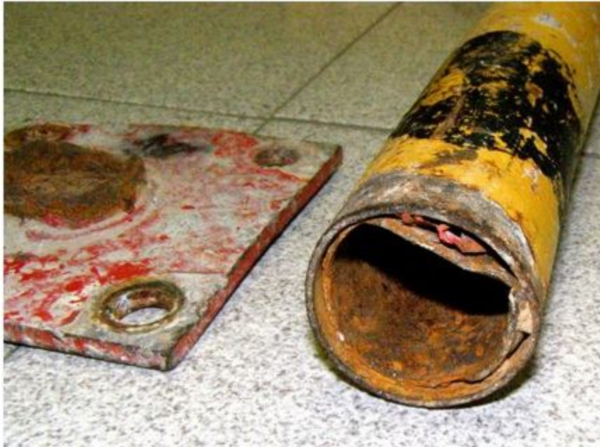
Fig 4.3. Vista de les zones de trencament. Es pot observar el fenomen de la corrosió
