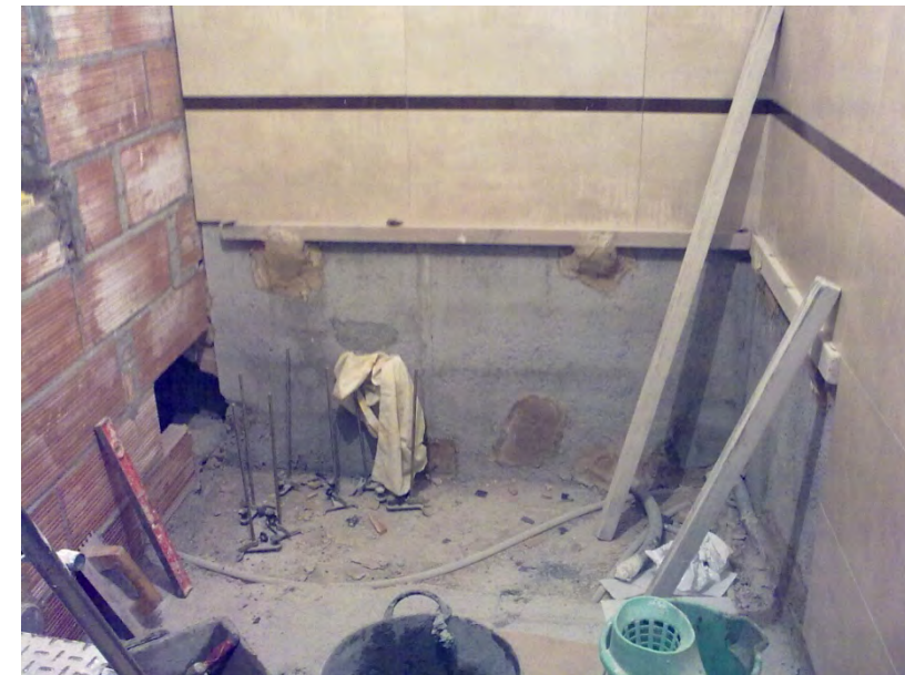
13.2.6/5. Imatge feta per l'autor d'un enrajolat de la marca Roca en un bany, on també s'aprecia la sanefa perimetral vidriada de color marró fosc.
