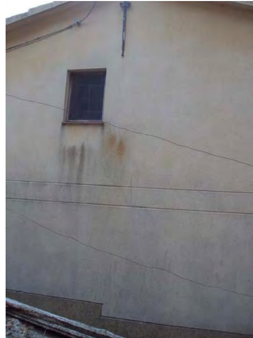
9.2.2/29. Rentat diferencial en l'escopidor d'una finestra de la paret Nord de la casa
