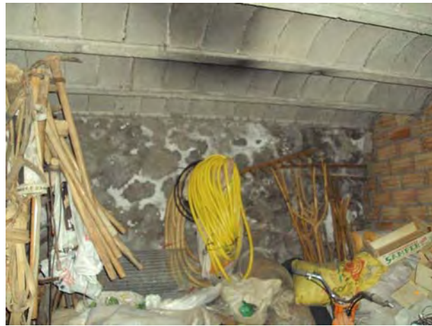
9.3/6. S'observa la presència de humitat en el parament del front
