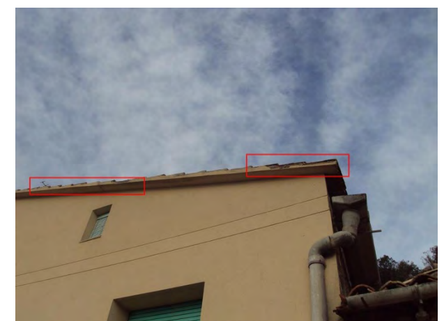
9.2.2/18. Despreniment en el voladís Sud de la coberta de la casa
