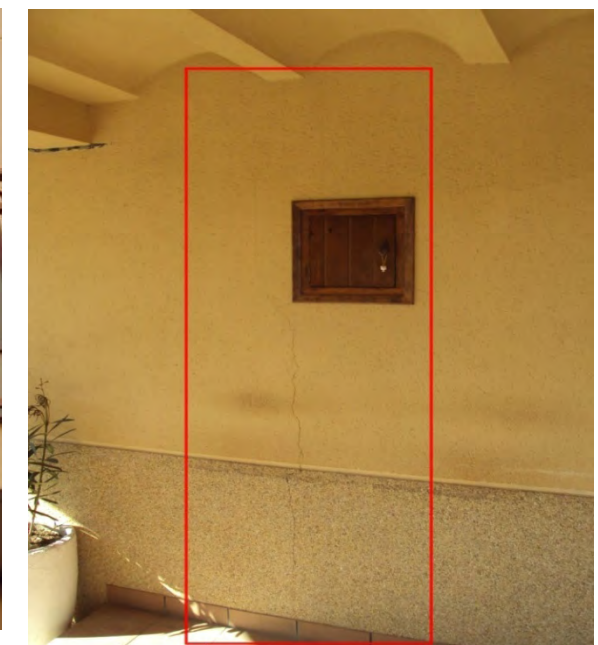
9.2.2/7. Fissura vertical neix a la biga i descendeix fins al paviment
