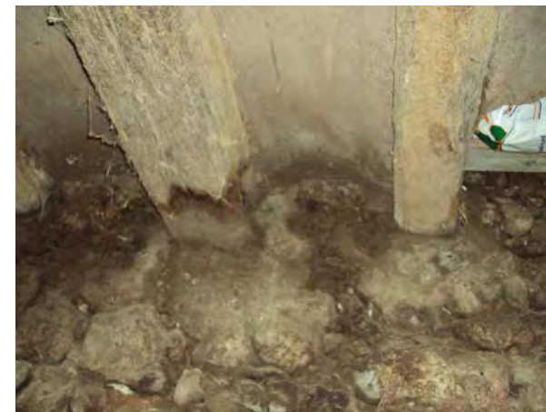
9.2.3/18. S'observa les floridures en els caps en contacte amb la paret, contingut alt de humitat
