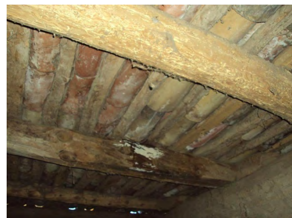
9.3/21. Taca de color blanc en la biga 47 per filtració de l'aigua de pluja
