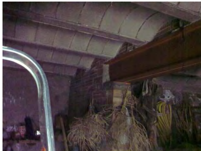
7.2.2.2/5. Jàssera estructural de biga metàl·lica IPE en el garatge "B" de la casa.
