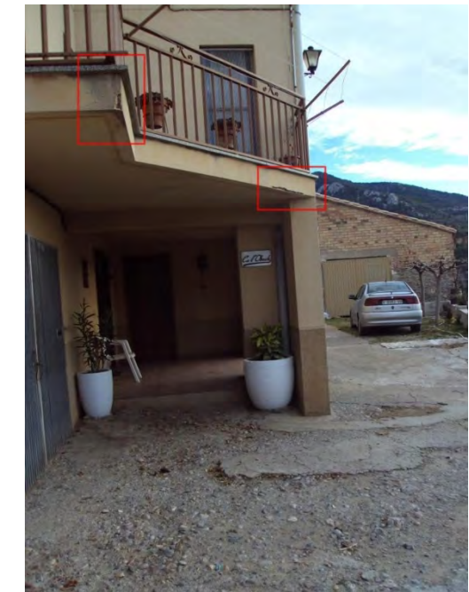
9.2.2/16. Despreniment en les zones més freqüents per l'evacuació de l'aigua de pluja
