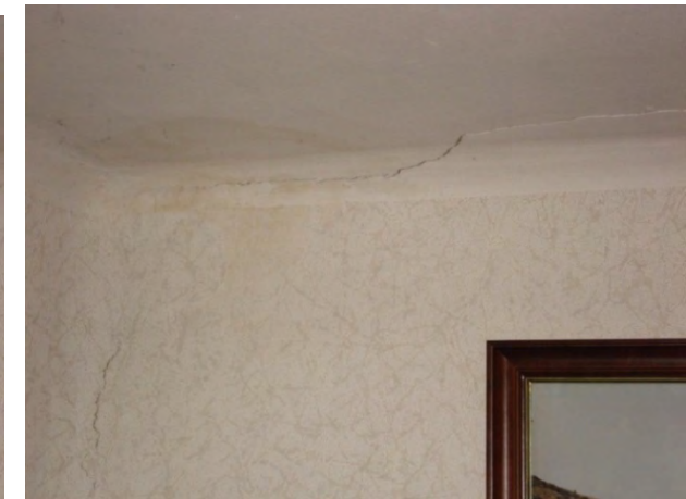
9.2.2/12. S'observa l'orientació de l'esquerda horitzontal en el forjat en la part dreta, continuant en el parament vertical
