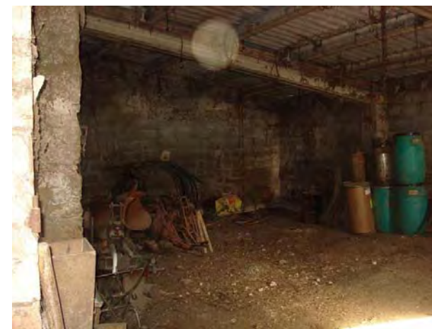
7.2.5/1. S'observa que en els corrals no existeix paviment, directament el sòl del terreny
