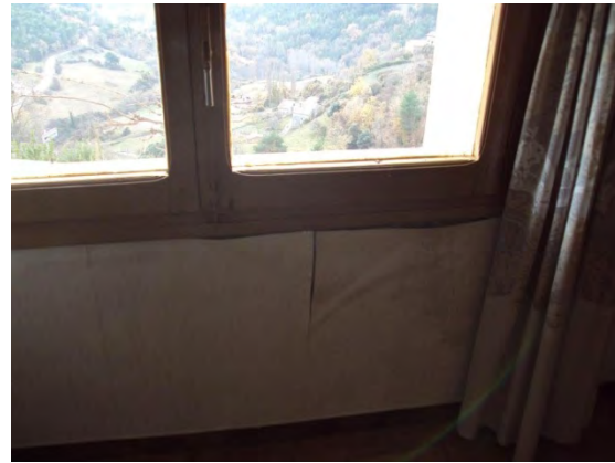
9.3/12. Humitat de filtració en la part inferior de la finestra, penetra per la junta en els dos materials
