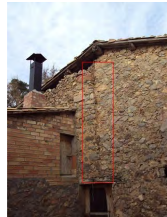
9.2.2/14. Fissura vertical en un parament vertical de la pallera
