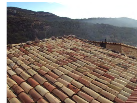
9.3/29. S'aprecia el trencament de peces i també peces mogudes de lloc
