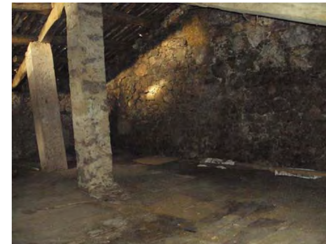
9.3/15. Planta primera s'aprecia la humitat en el parament de la cara Sud de la paller
