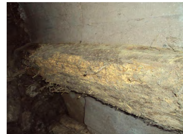
9.2.3/19. Podricions avançades en les bigues de fusta
