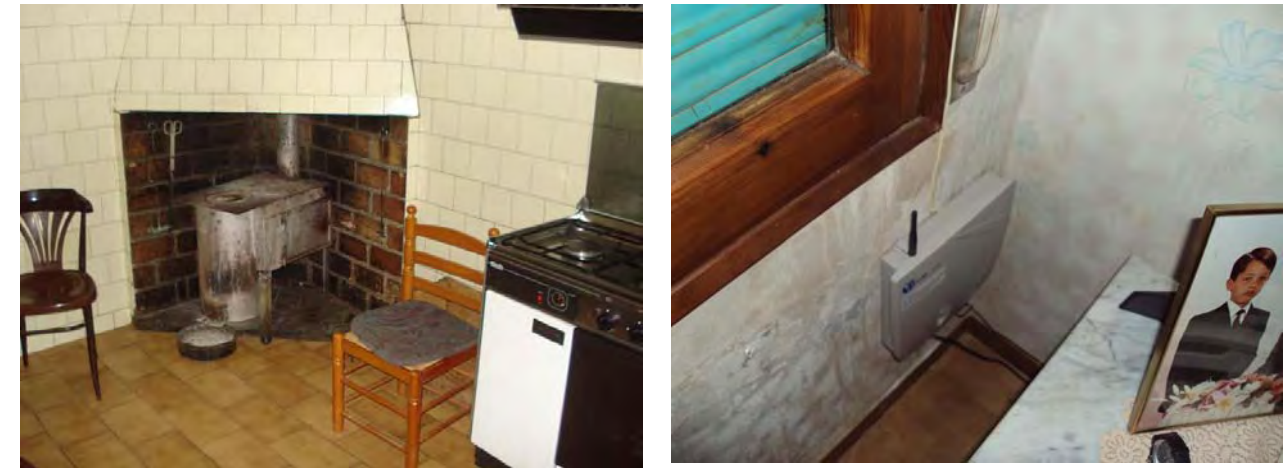
7.2.6/3. Sistema de calefacció a base d'estufes de llenya, ubicada en la cuina
