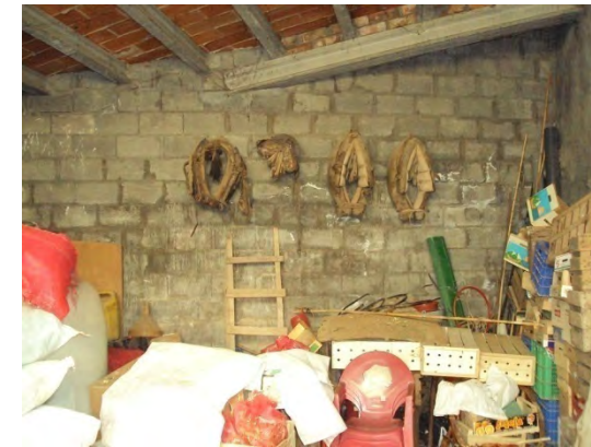
9.3/3. S'observa la línia que forma la humitat en el parament
