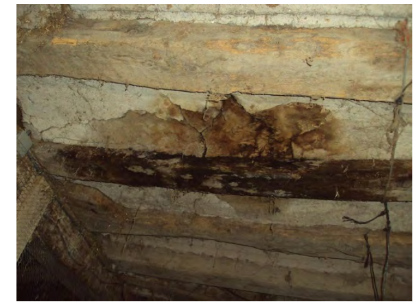
9.2.3/15. Biga 14 s'aprecia la presència de humitat i fongs en el centre
