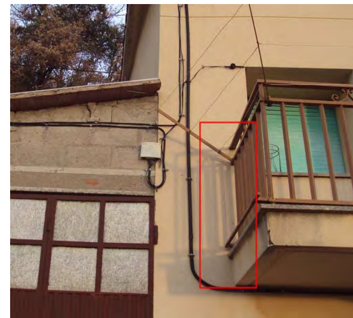
9.2.2/6. Fissura vertical en el parament vertical del balcó
