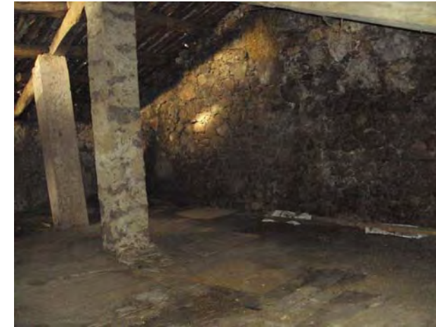
9.2.3/3 Vista en la planta primera on s'observa el mal estat del paviment
