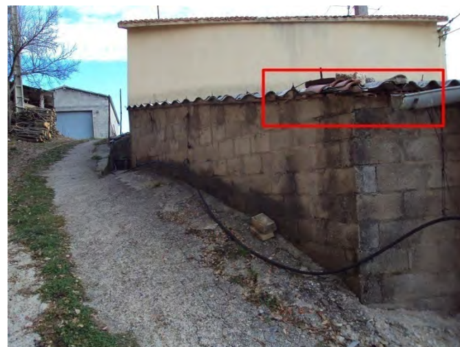
9.3/26. S'observa el trencament de les peces d'uralita en aquest edifici
