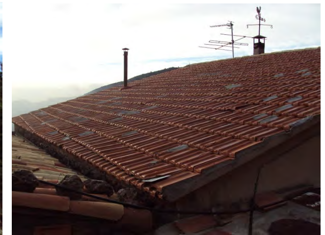
9.3/28. En color gris es veu la gran quantitat de teules deteriorades
