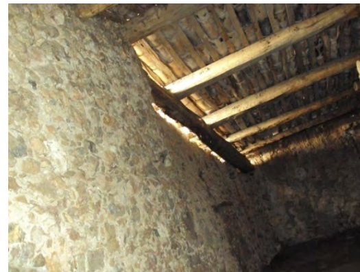
9.2.2/13. Desplom en el parament cap a l'exterior, també s'observa la biga superior
