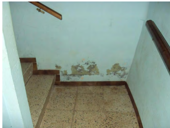
9.2.2/19. Despreniment de la pintura en la paret de l'escala
