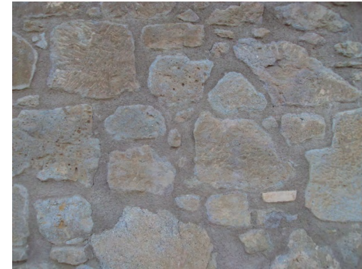
12/4. S'aprecia la reconstrucció amb les mateixes pedres i rejuntat amb morter de ciment de reparació
