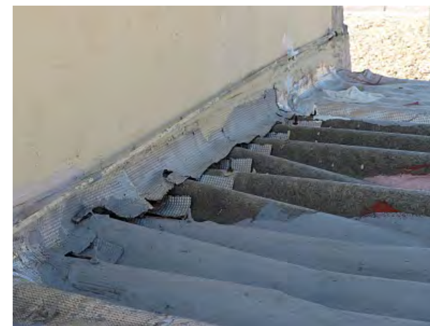
12/16. Imatge de la coberta en mal estat
