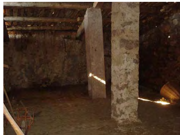
7.2.2.2/7. Vista on es veu els dos pilars de mamposteria de pedra en la planta primera de la pallera
