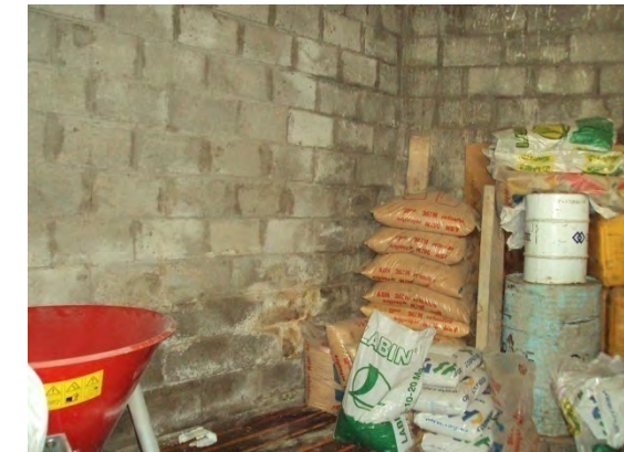
9.3/4. S'observa continuació de la humitat per filtració en el parament Oest
