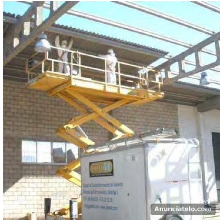
13.2.1/3. Imatge extreta de la pàgina Web de l'empresa "Gestion medio ambiental del amianto", s'observa l'execució material de l'enderroc
