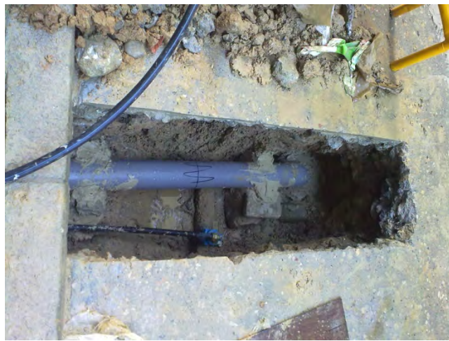
13.2.7/3. Fotografia feta per l'autor de l'escomesa d'aigua sanitària.
