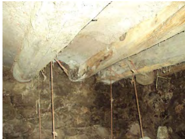
9.2.3/6. S'observa el guerxament en les dos bigues de la dreta
