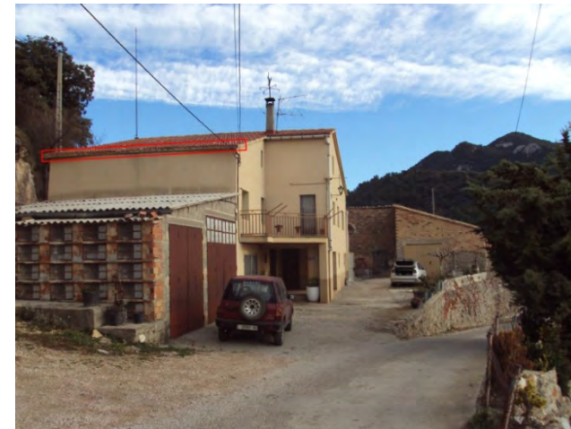
9.3/27. S'aprecia que en el voladís Oest de la casa les teules estan molt trencades
