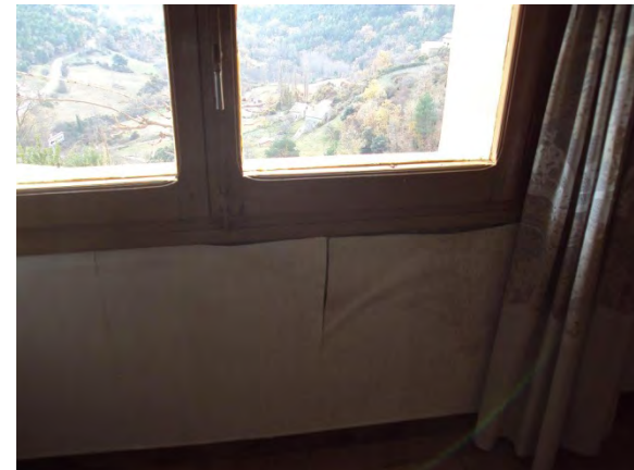
9.2.2/20. Despreniment del paper d'acabat en la part inferior de la finestra
