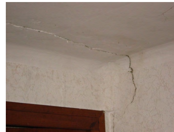
9.2.2/11. Fissura vertical esquerre, trencant el parament vertical
