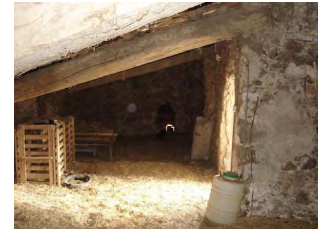
9.2.3/24. Acumulació de brutícia en el paviment del forjat de la pallera
