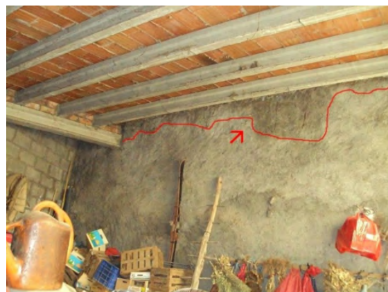
9.3/1. S'observa la línia que forma la humitat de filtració
