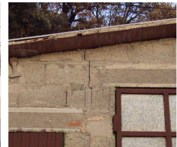
9.2.2/2. S'observa la fissura al pilar, entre les llindes de les portes
