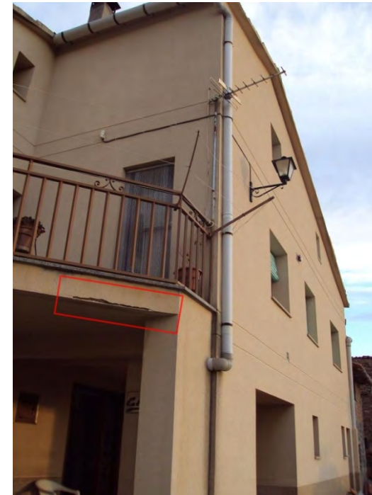
9.2.2/15. Despreniment en la inferior del voladís del balcó
