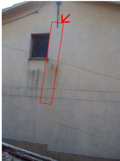
9.2.2/9. Fissura vertical i despreniment en la unió entre el parallamps i el revestiment
