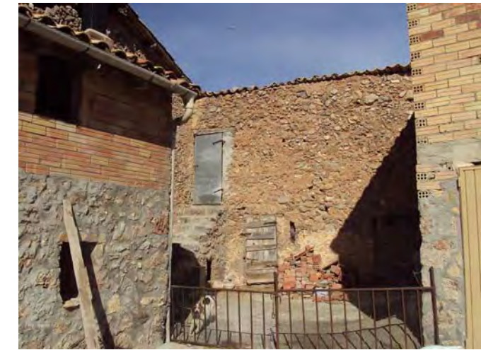
7.2.5/6. S'observa que als corrals els paraments verticals de mamposteria queda vista
