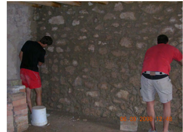
13.2.3.2/2. Imatge realitzada per l'autor d'operaris sense epis realitzant la consolidació dels paraments.
