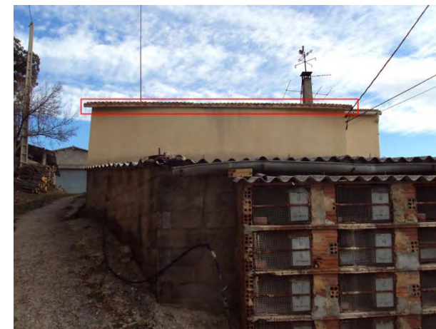
9.2.2/17. Despreniment per causes físiques en el voladís Oest de la coberta
