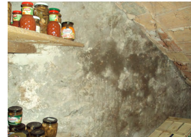
9.2.2/27. Pàtines en la part inferior de l'escala, s'aprecia gran quantitat de humitat en aquest parament
