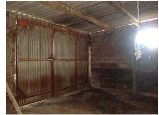
9.2.2/31. S'aprecia la presència de brutícia en tots els paraments
