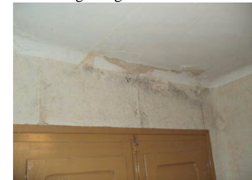
9.3/11. Humitat de filtració en el parament de la cara Sud
