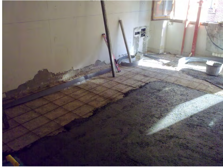
13.2.6/2. Imatge feta per l'autor capa de regulació de formigó armat i s'observa la banda de Pòrex en la unió entre paraments.
