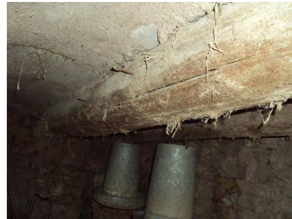
9.2.3/7. En aquesta imatge s'aprecia la clivella en el centre de la biga
