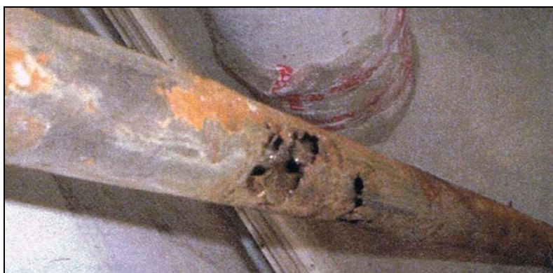
Figura 98: Eje motor totalmente deteriorado. Fuente: autor
