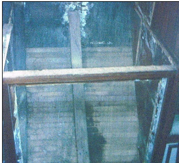
Figura 6: Vemos la mala reparación del forro en el espacio de neveras.
