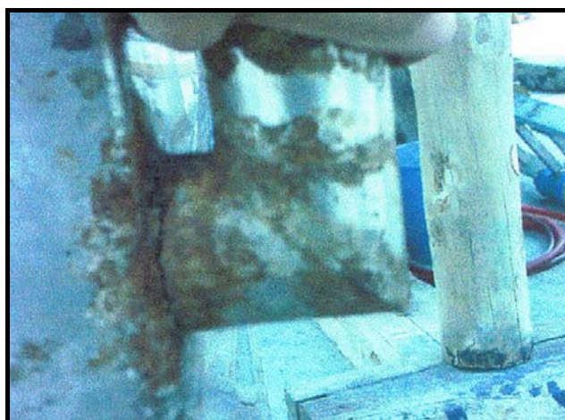
Figura 38: Fisura en el codo de admisión. Fuente: autor
