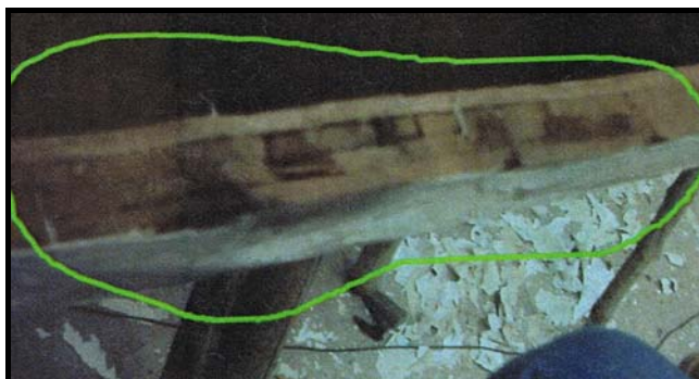
Figura 45: Deslaminado del forro. Fuente: autor
