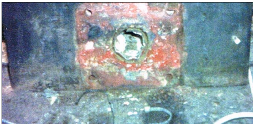
Figura 97: Rotura del eje dentro de la bocina. Fuente: autor
