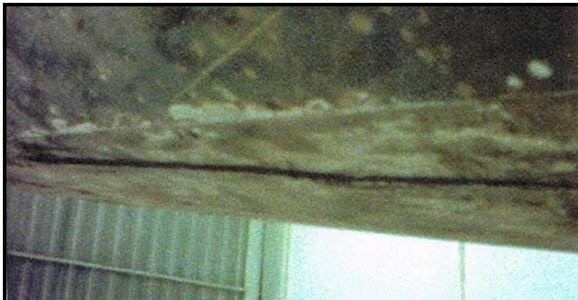
Figura 56: Deslaminado del taco de quilla. Fuente: autor
