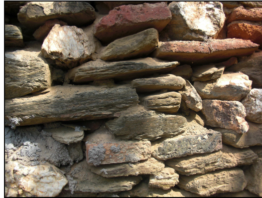
Fig. 4.2. Desaparició del rejuntat del mur de maçoneria a les façanes
