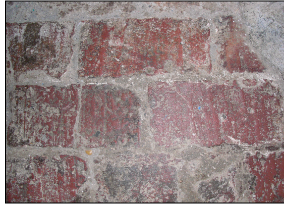
Fig.4.7.Desgast del paviment ceràmic de la bodega-safareig
