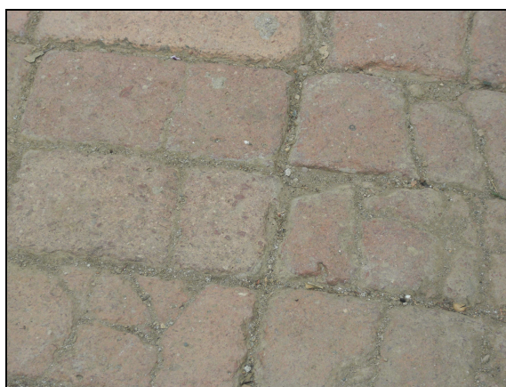
Fig. 4.11 Degradat del paviment de l'espai exterior
