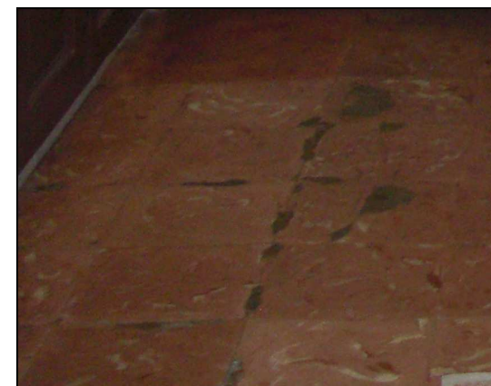
Fig.4.5.Desgast del paviment ceràmic hidràulic
