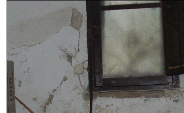
Fig.4.9.Despreniment del revestiment de la paret per la humitat
