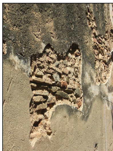
Fig. 4.10 Pèrdua del revestiment degut als agents atmosfèrics
