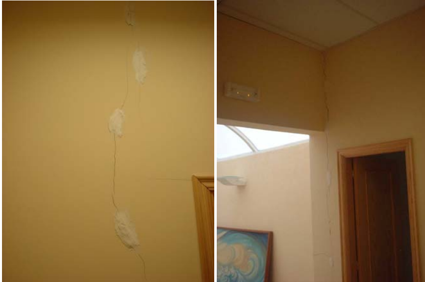
Figura 2 Fisuras en edificios por deformación excesiva de forjados
