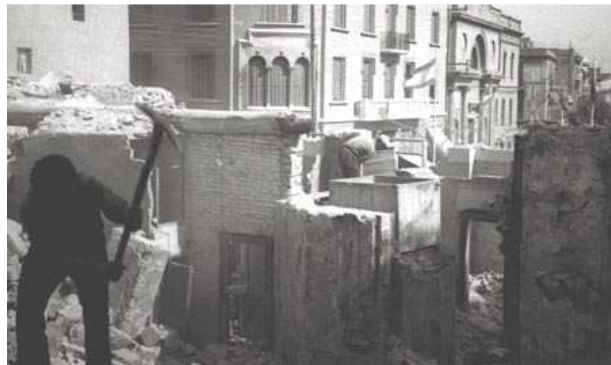
Enderroc de la casa de mobles Casa Guillem.
