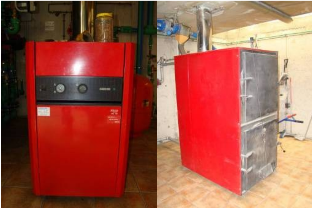
Imagen 4.12.- Interior Torre energia.Caldera de gas y biomasa para ACS y calefacción “Les Obagues” . Fuente: Elaboración propia.
