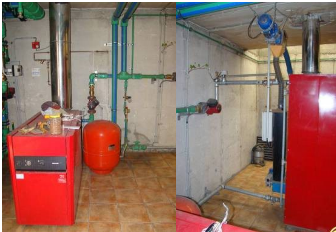
Imagen 4.4.- Interior Torre energia.Cakdera de gas y de biomasa. “Les Obagues”. Fuente: Elaboración propia.
