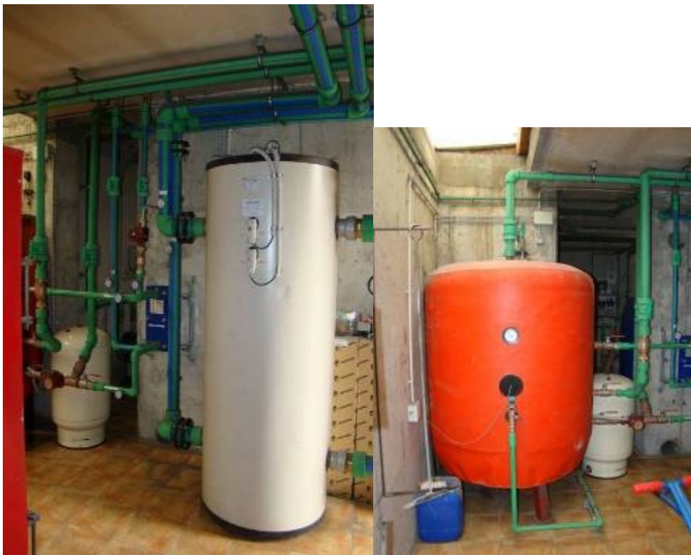
Imagen 4.6.- Interior Torre energia. Depositos Agua caliente y calefacción. “Les Obagues”. Fuente: Elaboración propia.
