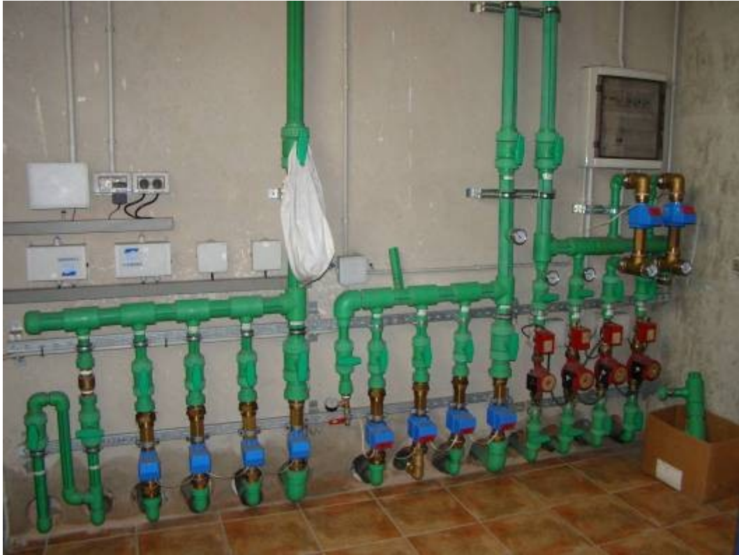
Imagen 4.7.- Interior Torre energía..Distribución de ACS y calefacción. “Les Obagues”. Fuente: Elaboración propia.
