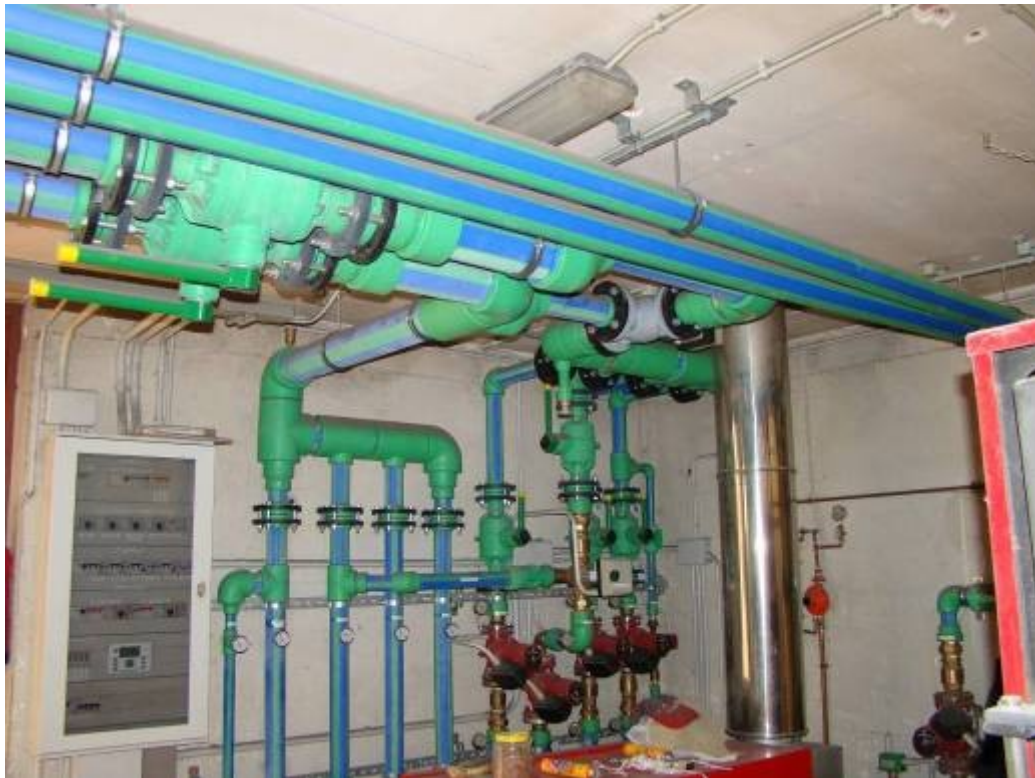
Imagen 4.10.- Interior Torre energía..Distribución de ACS y calefacción. “Les Obagues”. Fuente: Elaboración propia.
