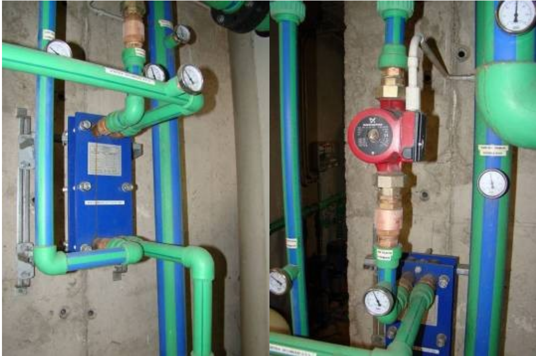
Imagen 4.11.- Interior Torre energia..Intercambiadores de calor .“Les Obagues” . Fuente: Elaboración propia.
