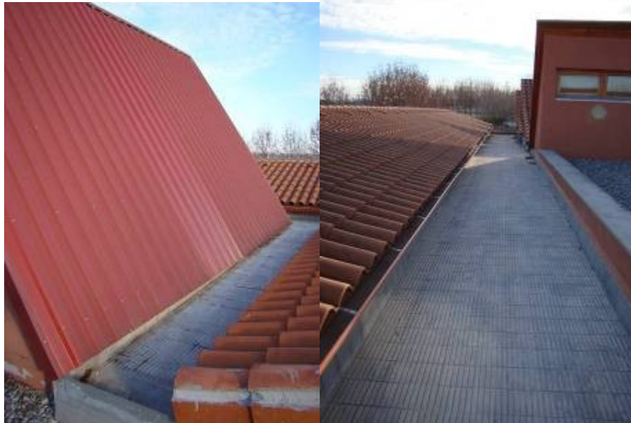
Imagen 6.1.- Vista de la cubierta edificio habitaciones para instalación ACS..“Les Obagues”. Fuente: Elaboración propia.
