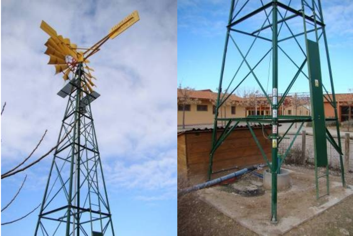
Imagen 3.2.- Vista exterior molino de viento para el bombeo del agua de pozo del acuífero subterráneo local. “Les Obagues”. Fuente: Elaboración propia.
