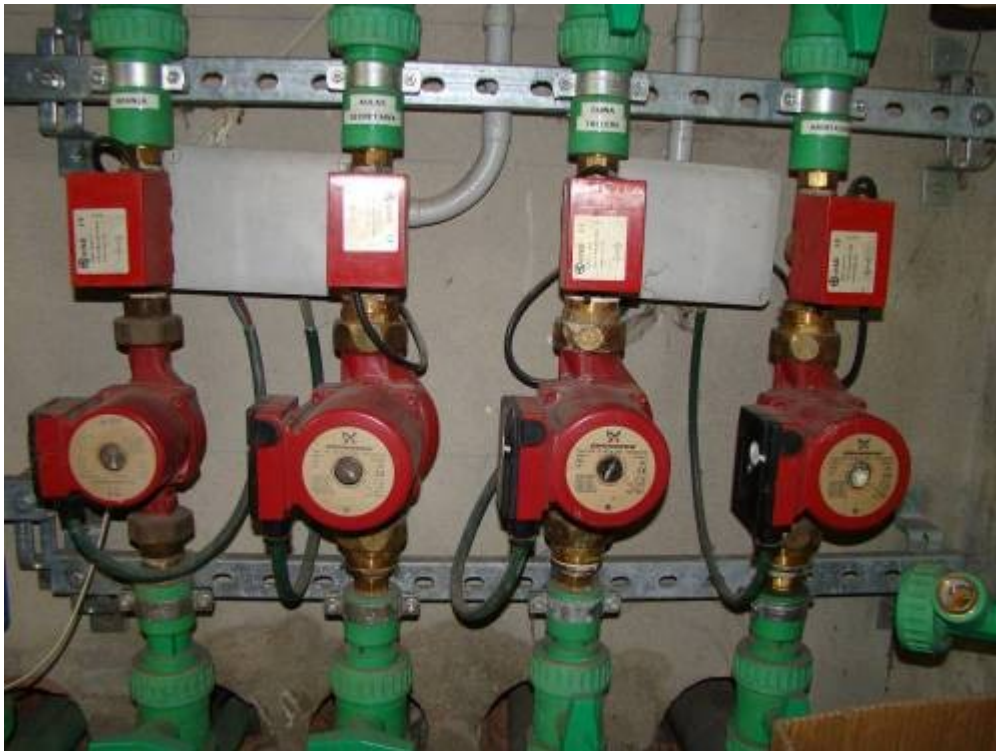
Imagen 4.8.- Interior Torre energía..Bombas Distribución de ACS y calefacción. “Les Obagues”. Fuente: Elaboración propia.
