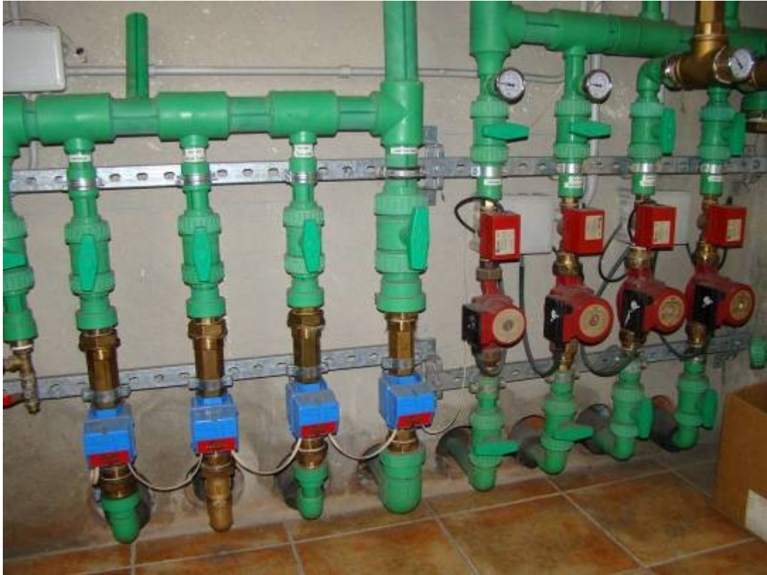
Imagen 4.9.- Interior Torre energía..Distribución de ACS y calefacción. “Les Obagues”. Fuente: Elaboración propia.
