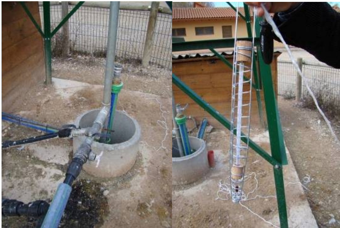
Imagen 3.3.- Detalle pozo bombeo y toma de datos temperatura . “Les Obagues”. Fuente: Elaboración propia.
