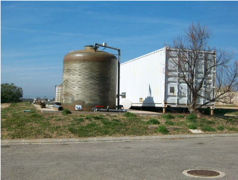
Foto 3: Contenidor de tractament terciari i dipòsit d'aigua tractada. Dins el contenidor s'hi troba el filtre sorra i el conjunt de canonades, instrumentació i vàlvules definits en el projecte de tractament terciari del Consorci de la Costa Brava any 2000.
