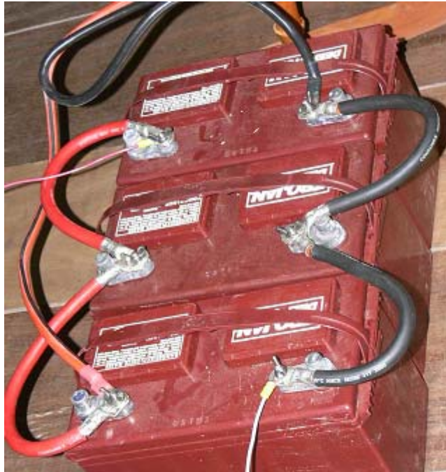
Fig 3.13 Les tres bateries Trojan connectades en paral·lel.
