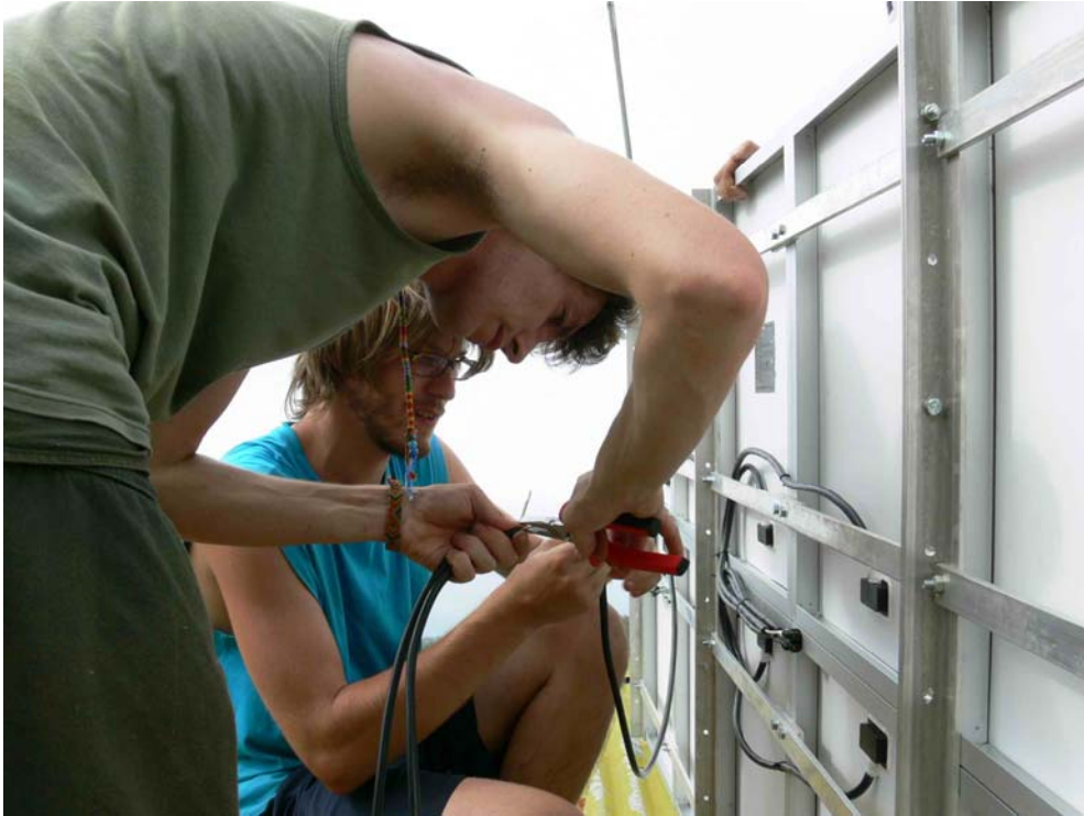
5. Primera parte de la instalación de los paneles solares en La Aurora.
