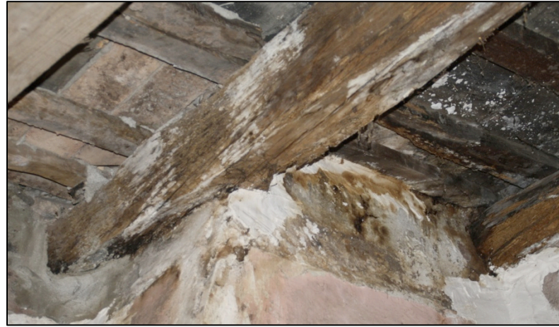
Foto 24: Les filtracions de coberta han malmès les bigues
