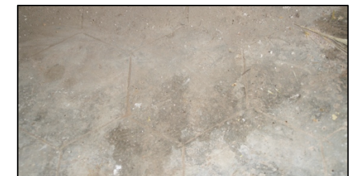
Foto 8: Paviment de formigó de la cuina
