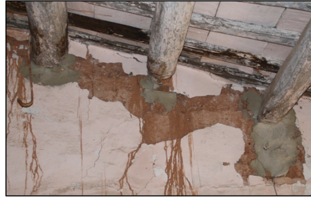
Foto 13: Despreniment a caps de bigues
