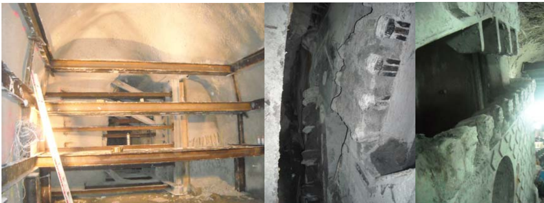
Figura 7.27 Fotografías de una galería de inspección y una tuneladora situada en ella.
