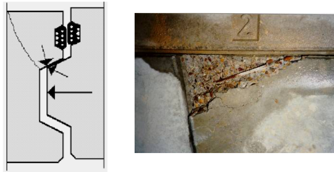
Figura 4.11 Esquema de formación de rotura por carga excéntrica de empuje y fotografía real del daño.
