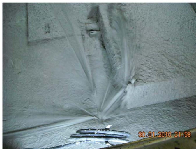
Figura 4.14 Rotura del sellado del anillo y entrada a presión del mortero en la cara interior del túnel.
