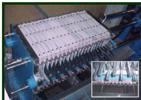
Con la instalación del filtro prensa hemos recuperado el vino que quedaba impregnado en las tierras de filtración de los filtros de bujías, utilizados para filtrar el vino.
