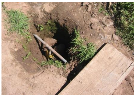
Trampa de agua. Las tuberías están enterradas.
