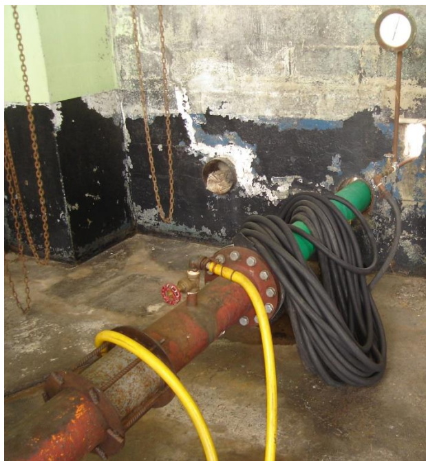
Figura I. 3. Conexión de salida del pozo 3
