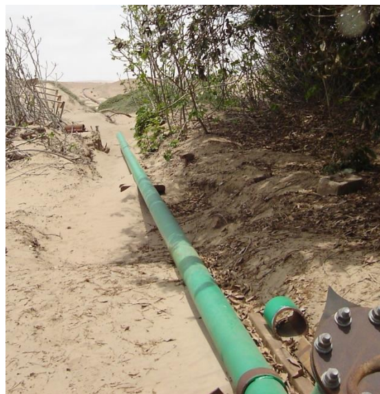
Figura I.5. Tramo de tubería de impulsión del pozo 4
