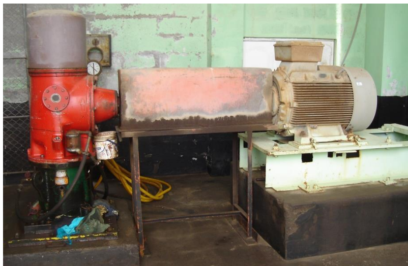
Figura I.2. Bomba actual del pozo 4
