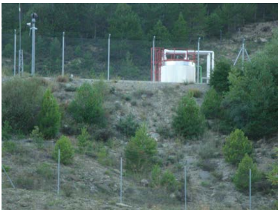
Uno de los depósitos cercanos a los pozos
