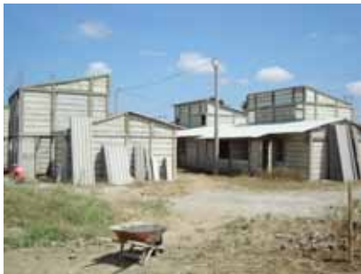
Fotografía 7. Panorámica de instalación de prefabricados confeccionados con eco-cemento, proveniente del reciclaje de cenizas volantes de hornos industriales. Palmira, Valle del Cauca.
