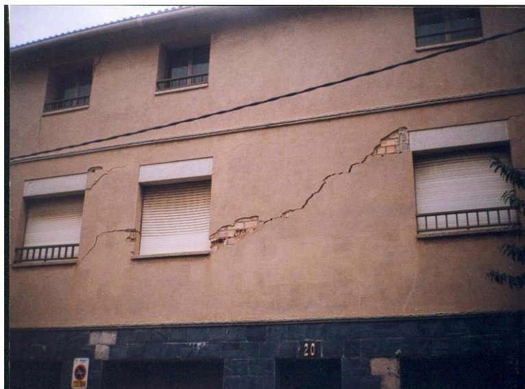
Aspecte de les conseqüències de l'esfondrament, sobre una de les vivendes
