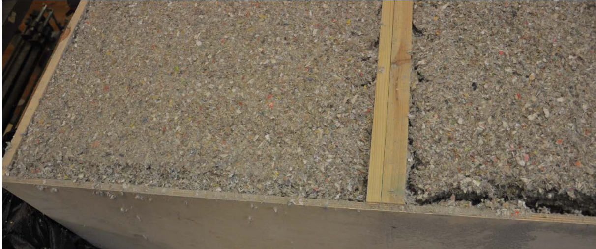
Kuva 7.3.15 Painuman vaikutuksia on korjattu vasemmassa lohossa lisäämällä varovasti eristettä (puukuitueriste 320 mm, normaali).
