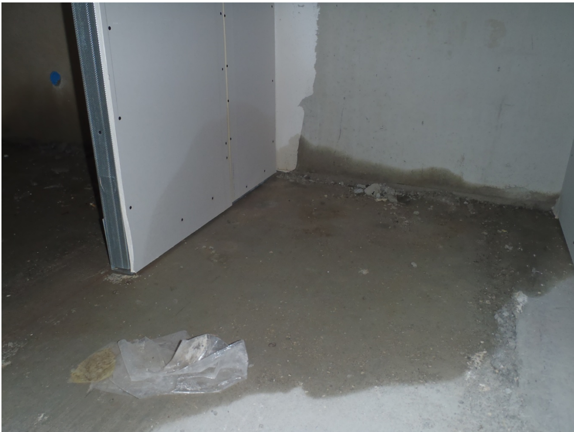
Kuva 9.5.1 Väliseinätyöt on aloitettu ennen vesikaton valmistumista ja ikkunoiden asennusta. Valumavedet ovat kasteleet levytykset.
