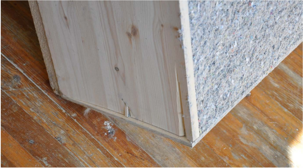
Kuva 7.3.11 Kuljetuksen aikana koerakenteeseen (320 mm paksu puukuitueriste) syntynyt vaurio reunapuussa.
