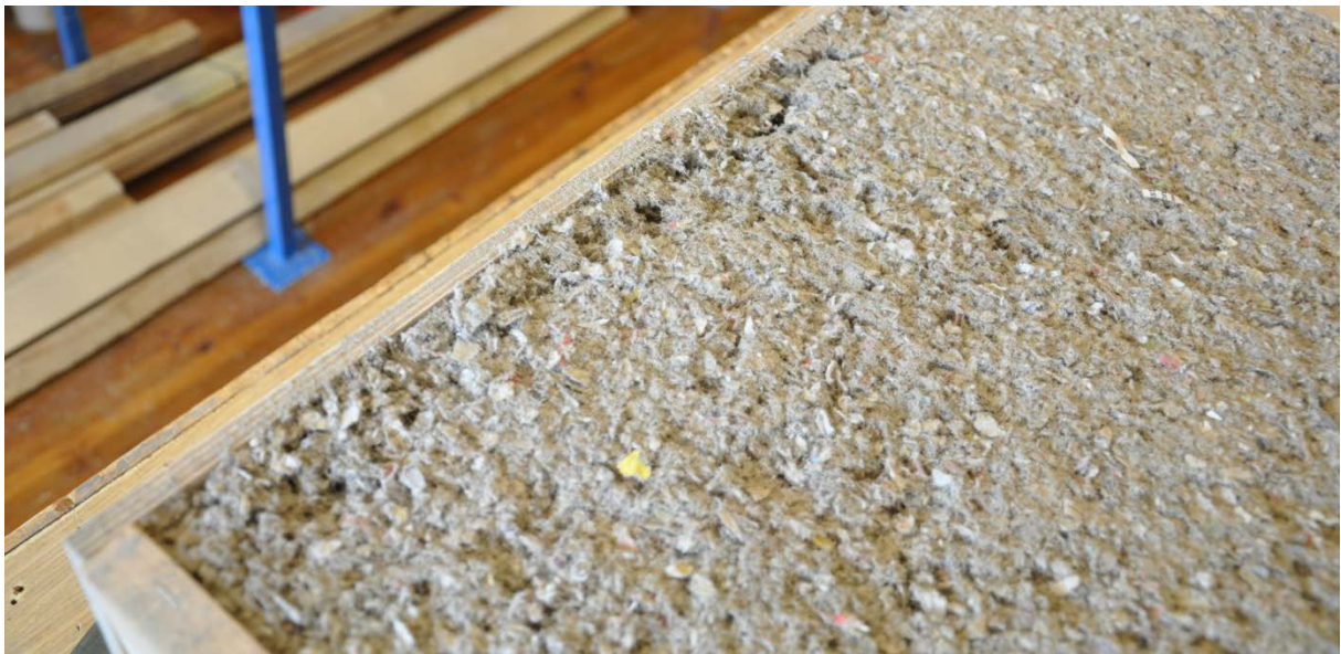
Kuva 7.3.13 Painuman jälkiä koerakenteessa, jossa ilmarakoa ei ollut vielä välittömästi puhalluksen jälkeen (puukuitueriste 200 mm, normaali).
