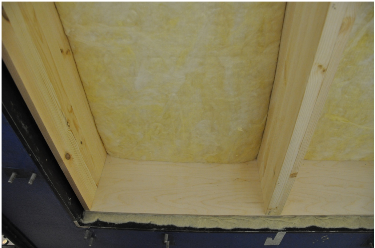
Kuva 7.3.7 Lämmöneristeen reunan pyöristymiä normaalisti asennetussa koerakenteessa.
