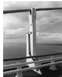
Fig. 2.31 External Hydraulic Damper on Normandy Bridge [Lecinq et al , 2003]
