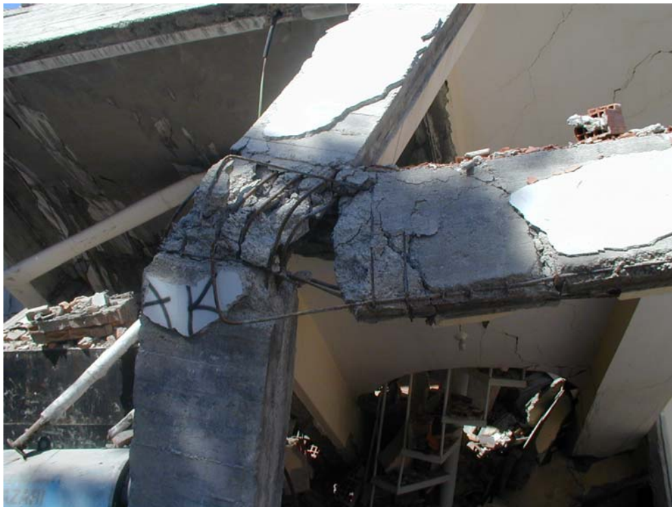
Foto 7.11 Cedencia del acero de refuerzo y pérdida de sección en junta.
