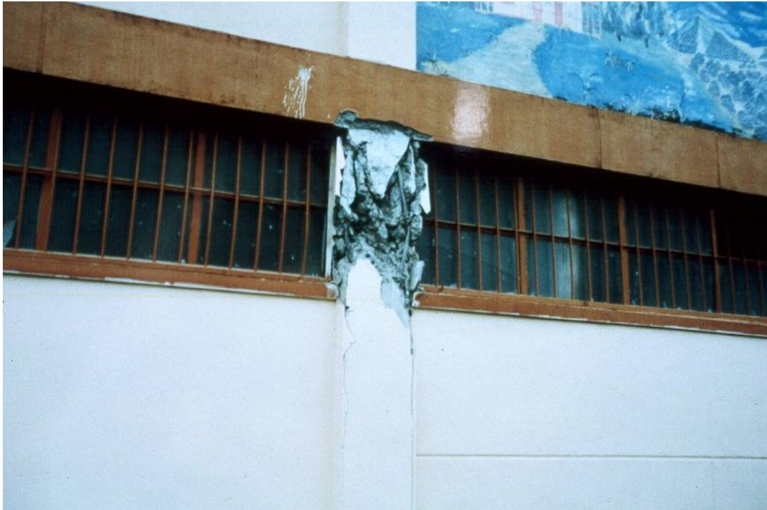
Foto 7.6 Efecto de falla por cortante de pilar.
