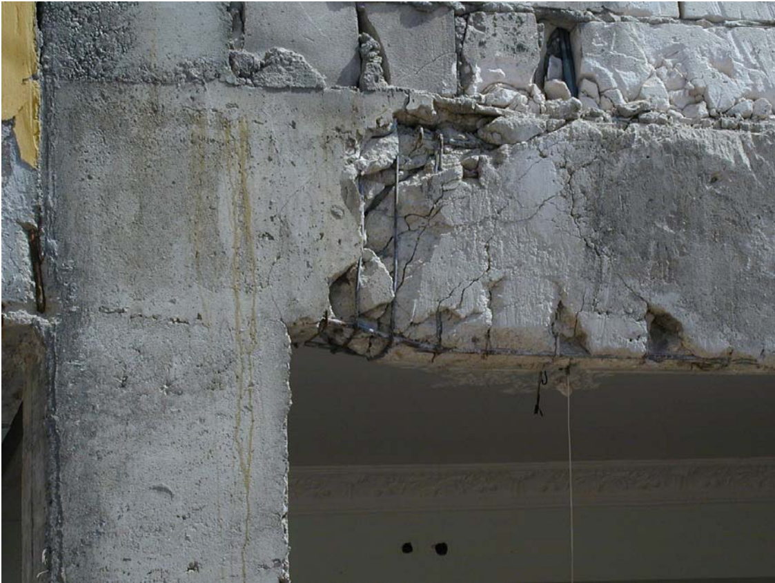
Foto 7.12 Formación de rótula plástica en viga.
