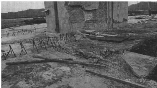
Fig. 3-48 Falla en el tablero, cerca de la pila (Chang et al, 2004)
