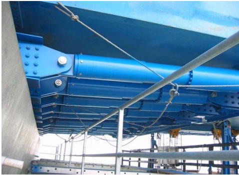
Fig. 5-17 Amortiguadores del puente Coronado, San Diego, USA (Gentileza de Taylor Devices Inc.)
