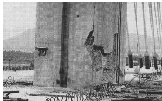
Fig. 3-49 Falla en pila central (Chang et al, 2004)
