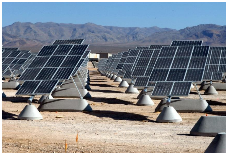
Figura 6 Col·lector solar (també anomenat captador solar)
