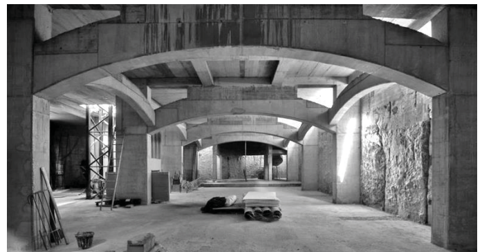
Figura 3. Estado actual de las obras del sótano de la Iglesia Ortodoxa Rumana de Barcelona. [ http://www.bisericabarcelona.es/ ]
