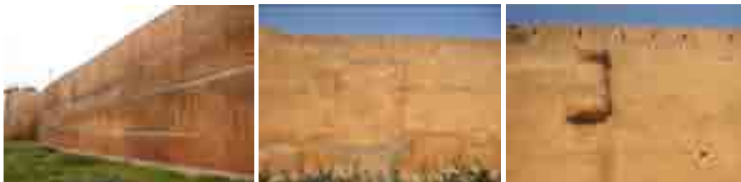
Fig. 2: Détail d'anomalies constructives dans les Murailles à Salé et à Rabat
