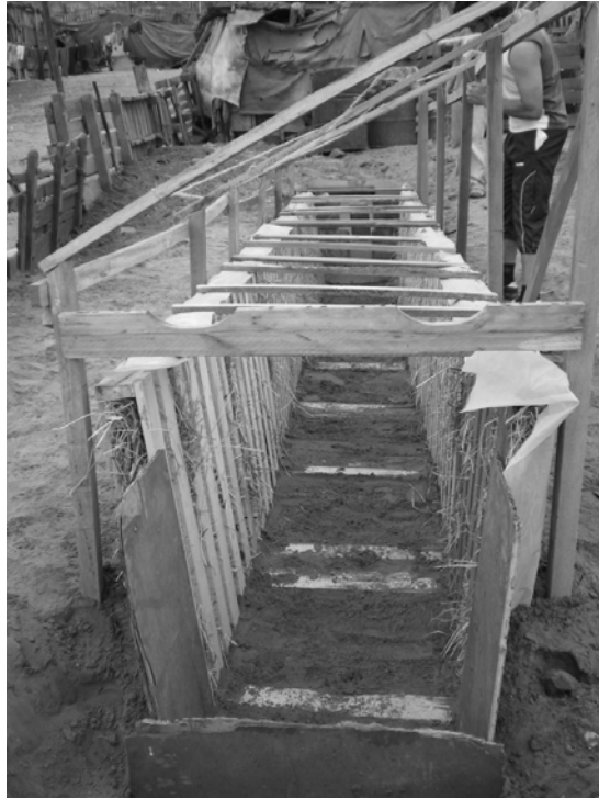
Figura 2. Cuna del biodigestor de manga y estructura del invernadero.
