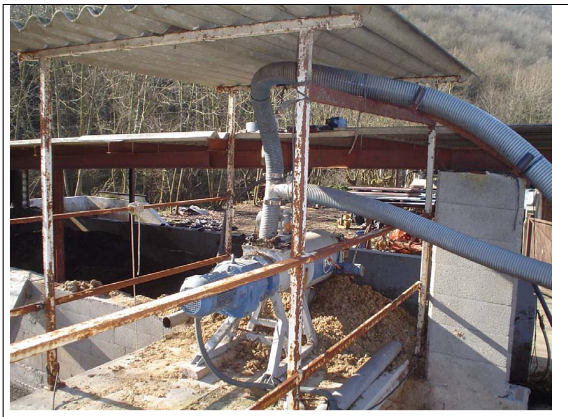
Figura 3. Tamiz para la deshidratación de purines (explotación ganadera Canalias, en la Vall de Bianya)
