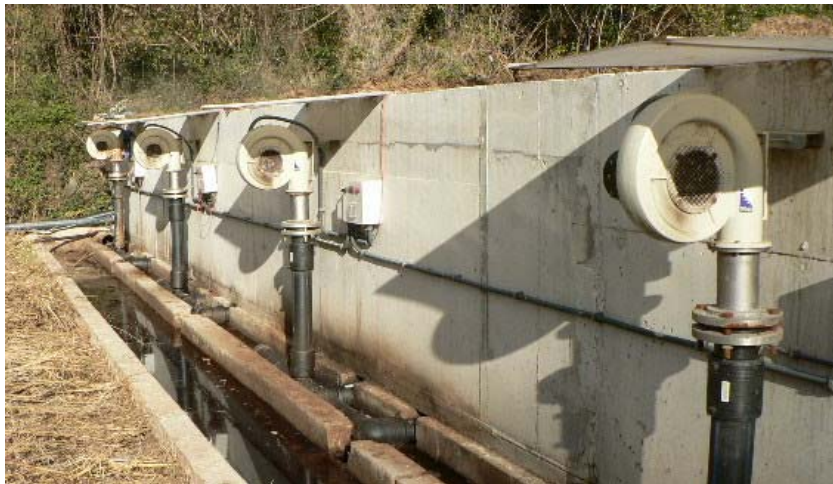
Foto 5. Batería de ventiladores que inyectan el aire a cada uno de los silos (Cooperativa La Fageda - Santa Pau). Se puede observar la canalización que conduce los lixiviados hacia una fosa, desde donde son bombeados a la balsa de purines.
