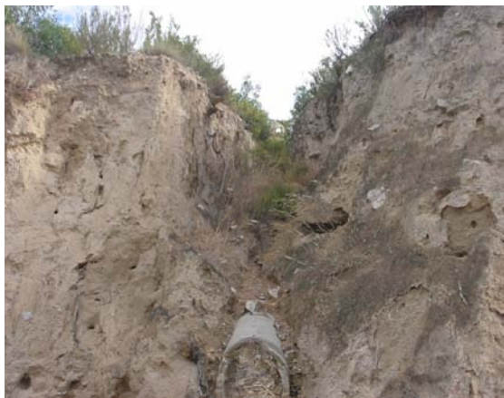
Foto 13. Restos del tubo del malacate, al borde del camino.
