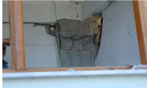
Figura 14: Columna con daño fuerte.
