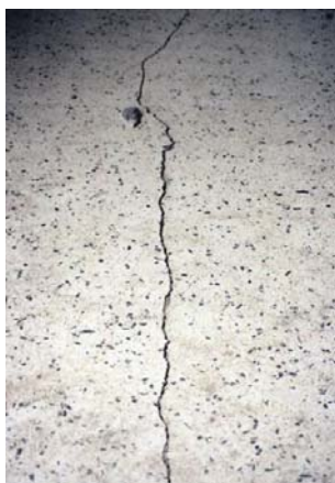
Figura 19: Entrepiso con daño moderado.
