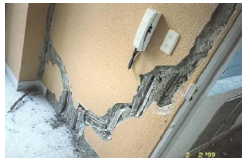
Figura 16: Muros divisorios con daño moderado.
