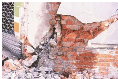
Figura 18: Muro de carga con daño fuerte.
