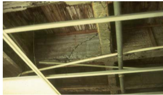
Figura 15: Viga con daño moderado.
