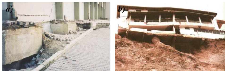
Figura 5: Condiciones del suelo: a) Licuación del suelo; b) Deslizamientos del suelo.
