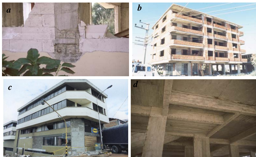
Figura 6: Condiciones preexistentes: a) Mala calidad en la construcción; b) Irregularidades verticales, piso blando; c) Irregularidades en planta; d) Mala configuración estructural: algunos elementos están fuera de los ejes principales.
