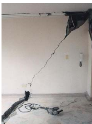
Figura 20: Particiones con daño fuerte.
