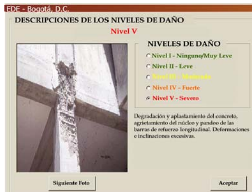
Figura 11: Descripción del daño severo en columnas de concreto que ayuda al proceso de evaluación.
