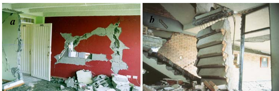
Figura 4: Daño en elementos no estructurales: a) Daño severo en muros divisorios, b) Daño fuerte en escaleras.
