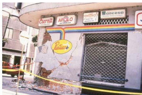
Figura 17: Edificio de la zona cafetera de Colombia dañado durante el terremoto de Enero de 1999.
