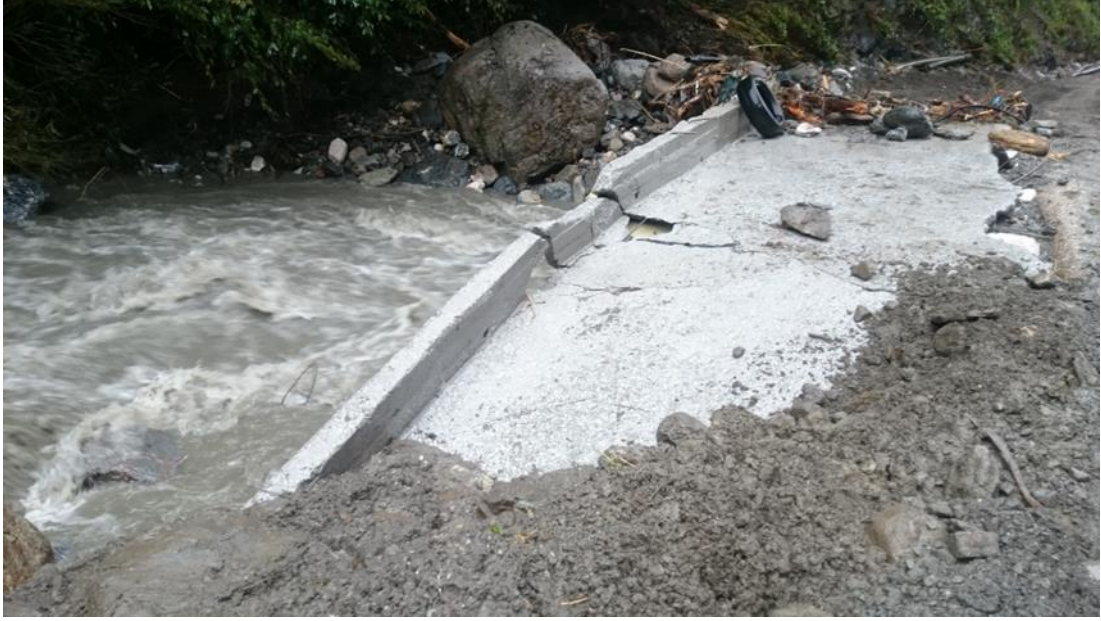
Şekil 5.4. Sapanca Mahmudiye Deresi membasında hasar alan sanat yapısı
