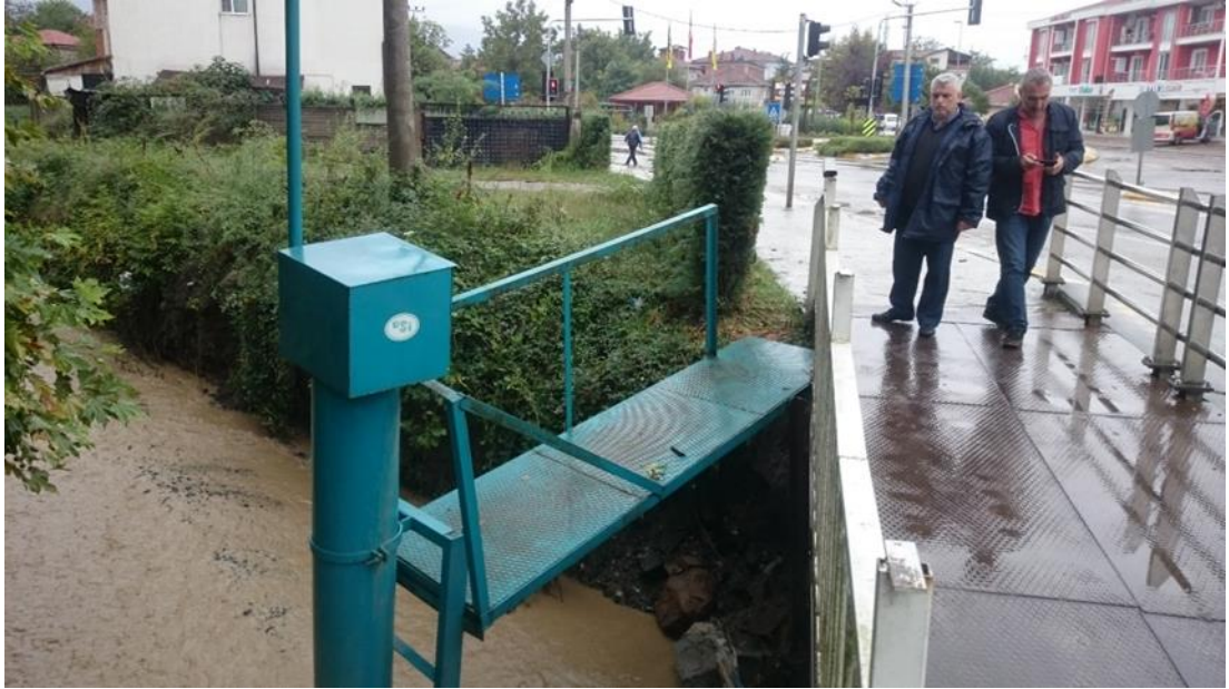
Şekil 5.10. Sapanca Keçi Deresinde hasar gören DSİ AGİ tesisi
