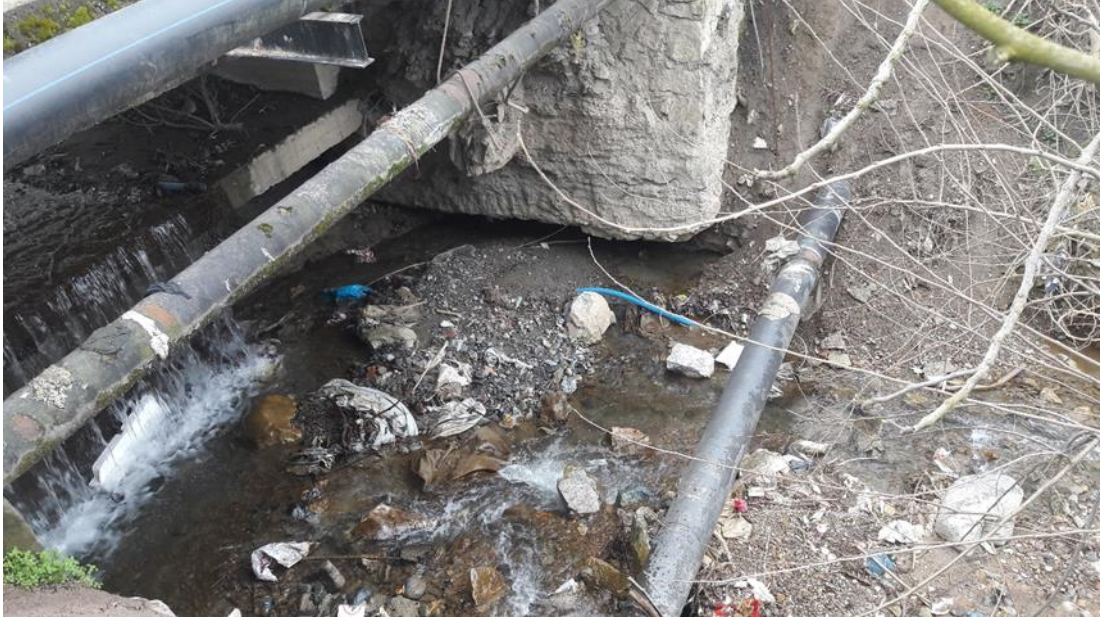
Şekil 2.8. Sakarya Sapanca Keçi Deresinde akışı engelleyen ve kesiti daraltan içme suyu boruları
