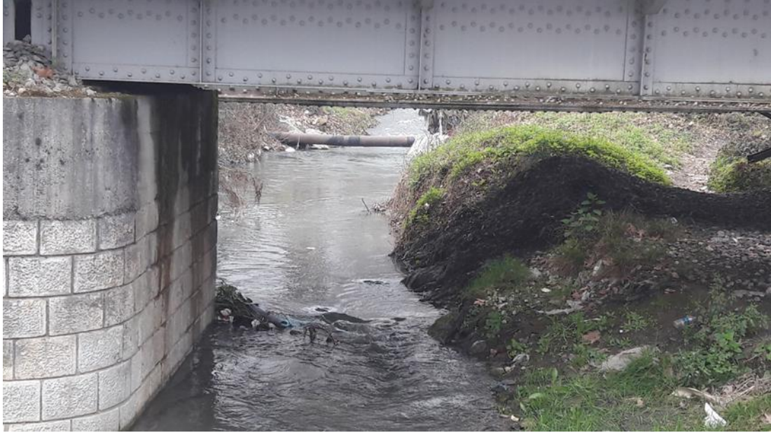
Şekil 2.4. Sakarya Sapanca İstanbulderesi yatak içinden geçen içme suyu borusu ve kesiti daraltan rusubat
