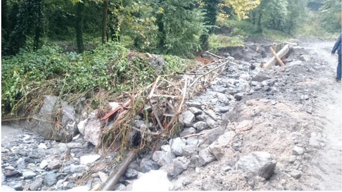
Şekil 5.3. Sapanca Mahmudiye Deresi membada hasar gören elektrik direği
