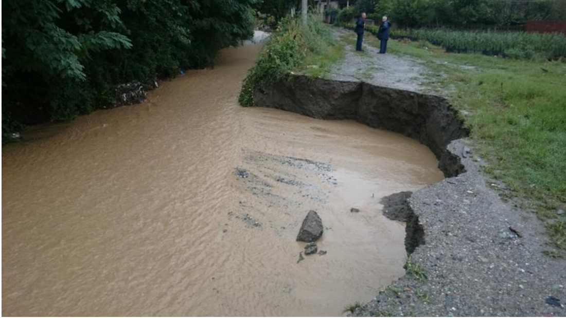
Şekil 5.11. Sapanca Keçi Deresinde hasar gören yol durumu
