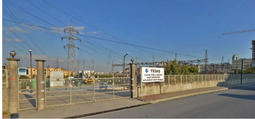
Şekil 2.12. Beylikdüzü trafo merkezi
