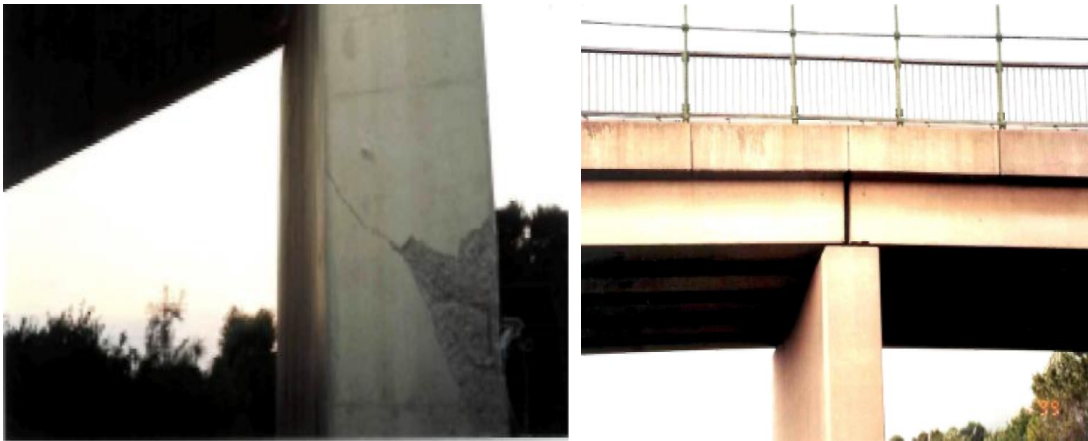
Şekil 4.17. Arifiye üstgeçidi orta ayağı , hasar gören diğer bir köprü
