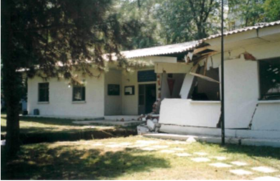
Şekil 2.14. Fay kırığı Gölcük Deniz Üssünde bir binayı yırtarak geçiyor. Şekilde farkedilen düşey atım fay hareketinden değil, yakın plandaki zeminin denize doğru kaymasından ve oturmasından kaynaklanıyor.
