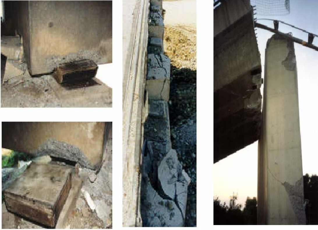
Şekil 4.18. Arifiye üstgeçidi deprem takozları ve elastomerleri
