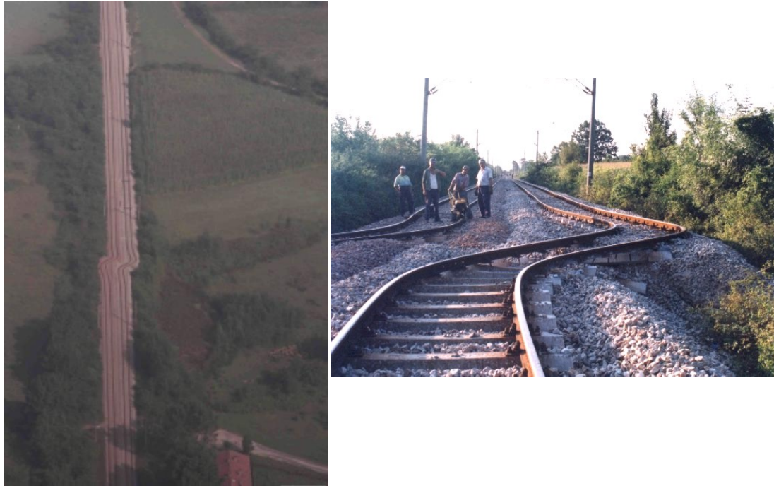
Şekil 2.18. Arifiye'de fay kırığının ve atımının demir yolunda yaptığı deformasyon.
