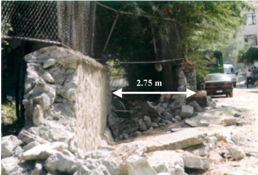
Şekil 2.13. İki fay segmenti arasında kalan duvar parçası ve 2.75 metre atım ölçülen segmentin yakın plan görünümü.
