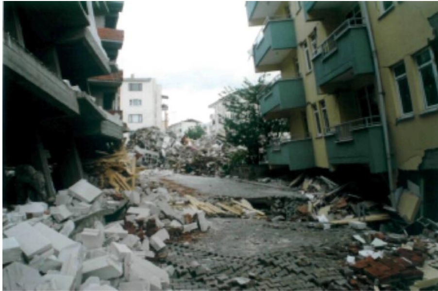
Şekil 2.15. Fay kırığı Gölcük Deniz Üssünden çıkarak Yüzbaşılar Mahallesinde yoğun yerleşim bölgesine giriyor ve önüne çıkan binaları adeta parçalayarak ilerliyor. Fay kırığının tam üzerinde depreme dayanıklı yapı yapmak mümkün değildir. Bu özellikteki bölgelerin hassas şekilde belirlenerek iskana kapalı tutulması gereklidir.
