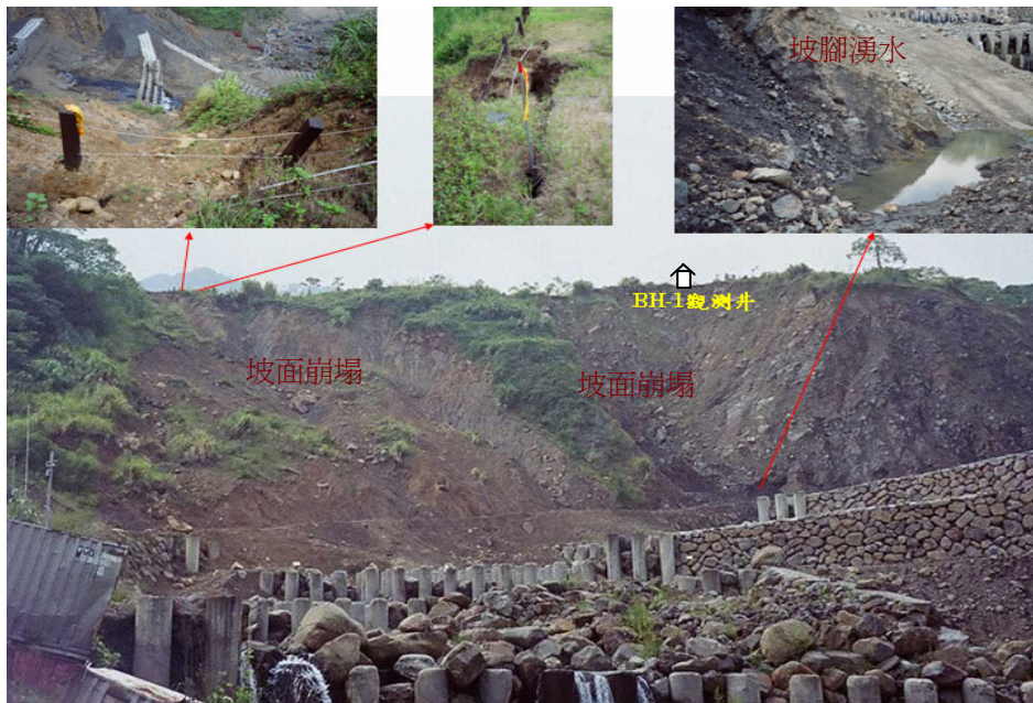
圖 13. 溢洪道南岸邊坡崩塌情形
