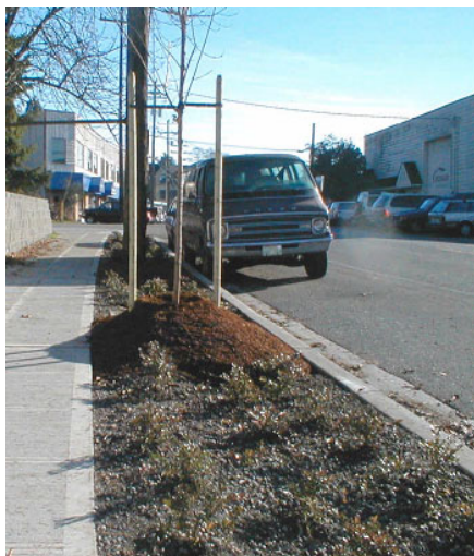
圖 4. Blakeley 有側緣溝蓋的線性生物貯留排水系統
