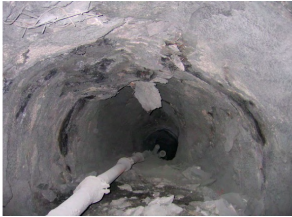
图 4 1 200 m 充填回风巷变形照片
