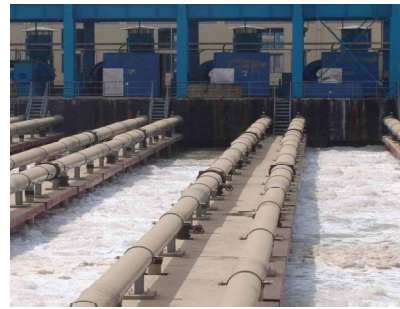
图 2 脱硫海水曝气池
