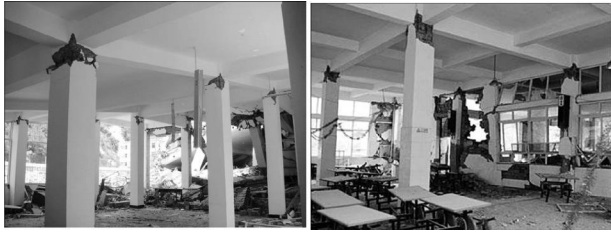
图2 汶川地震中“强梁弱柱”破坏(漩口中学)
