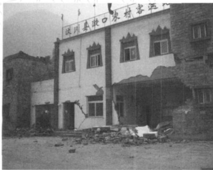
图2 纵墙破坏(汶川地震)
