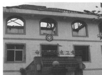
图1 屋顶破坏(汶川地震)
