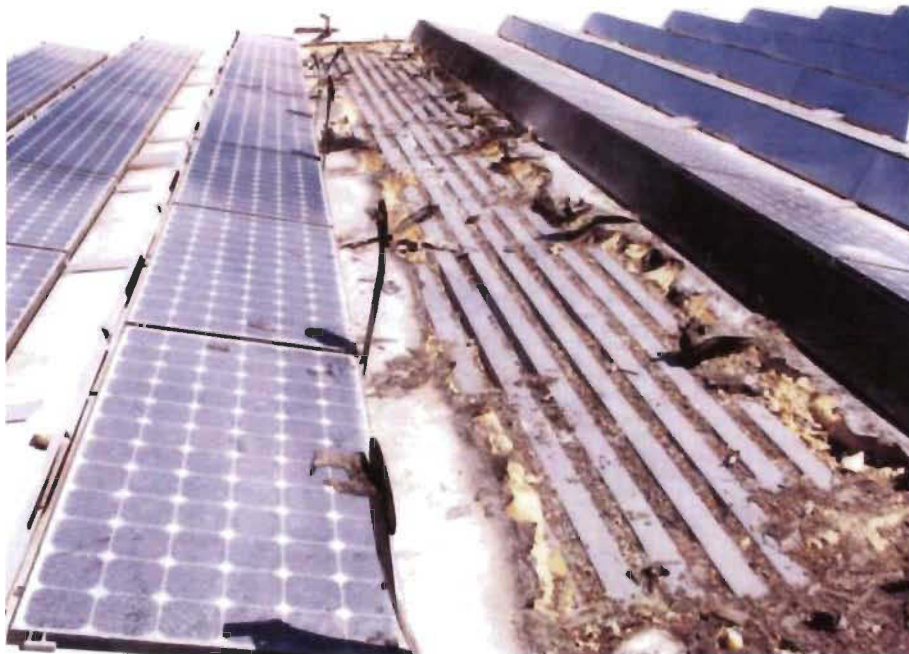
Figure 3-1 Centrale photovoltaïque de 383 kWc à Bakersfield brûlée en 2009 [16]
