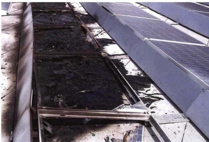
Figure 3-2 Centrale électrique de 1,208 MWc à Mount Holly, Caroline du Nord brûlée en 2011 [16].
