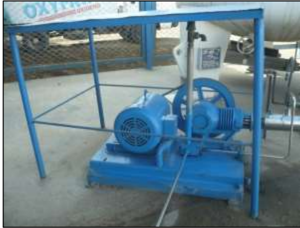
Figura 6. Compresor. Fuente: Elaboración propia.
