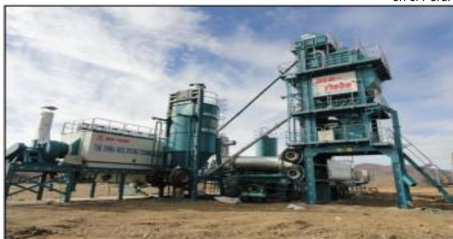
Figura 08. Ejemplo de planta de asfalto en caliente. Fuente: Chuman, 2018, p. 28, tomado de Planta de Asfalto ASTEC – Propietario Consorcio “VARGAS”, Ubicación: Paraje La Huaycha – Concepción,
