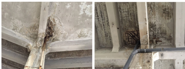
Figura 2.- Estado de parte inferior de forjados cercanos a desagües y bajantes de planta alta
