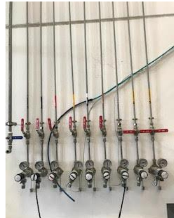
Imagen 29: Tomas de gas
