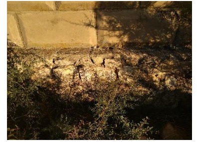
Encuentro de apoyo del murete del zócalo con la cimentación. Muelles de mercancías. Foto propia.
