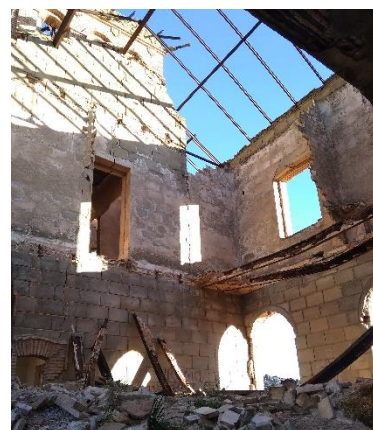
Vista interior de las ruinas del edificio de viajeros de Pitarra. Foto propia.
