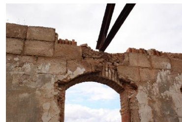
Apoyo fallido de las cerchas metálicas sobre el dintel de ventana. Foto Mario Benedi.
