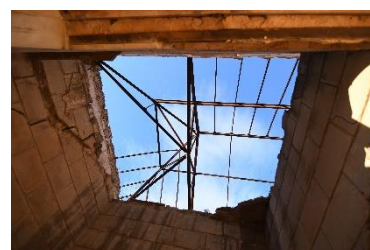
Foto del hueco de la escalera. Inexistencia de cualquier elemento de cobertura. Foto Paula Aguilar.
