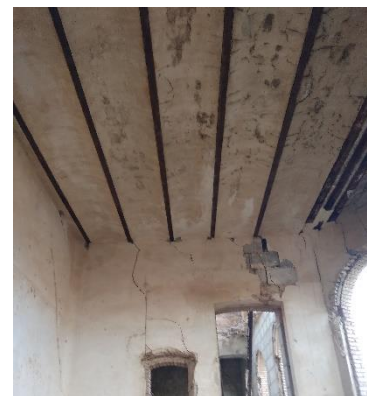
Revestimiento del espacio del inter-eje del forjado de la planta baja en los espacios de espera de viajeros. Foto propia.
