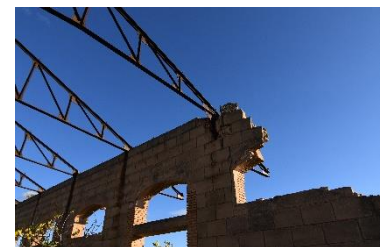
Grietas y corrosión en las cerchas metálicas y el paramento que las soporta. Foto Paula Aguilar.
