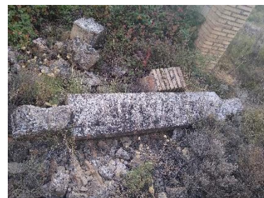
Restos del dintel que quedaría ubicado encima del hueco de las puertas de los muelles y que permitiría dividir el portón de acceso. Foto propia.
