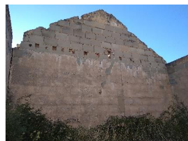
Interior de una casilla ferroviaria. Se aprecia los huecos de apoyo del forjado. Foto propia.
