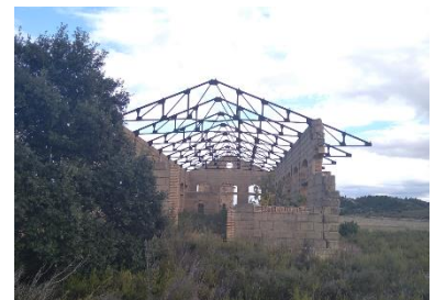
Colapso de la fachada testera secundaria de los muelles de Alcorisa. Foto propia.
