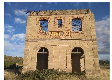
Grieta en esquina de la fachada Sur-Este del edificio de viajeros. Foto propia.
