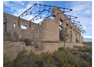
Colapso del muro del edificio de viajeros. Foto propia.
