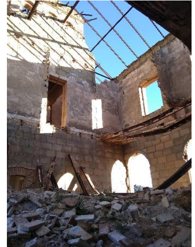
Restos del colapso total del forjado de la estación de Pitarra. Foto propia.
