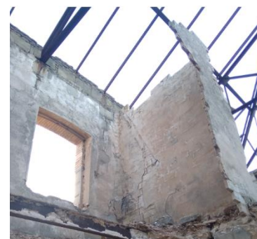
Restos de la composición de la tabiquería de la planta superior del edificio de viajeros de Pitarra. Foto propia.
