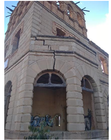
Grieta importante en la esquina superior del balcón. Foto propia.
