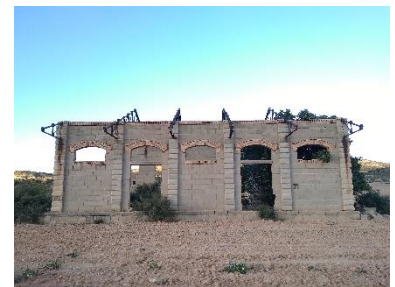
Alzado del edificio de muelles de mercancías de la estación de Pitarra. Apoyo de cerchas sobre pilastras. Foto propia.
