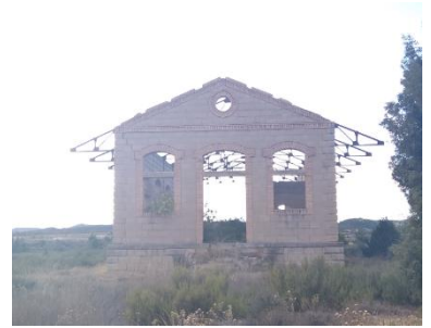
Fachada testera principal de los muelles de mercancías de Alcorisa. Foto propia.
