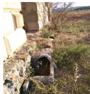
Tubería perimetral de hormigón para la evacuación. Foto propia.
