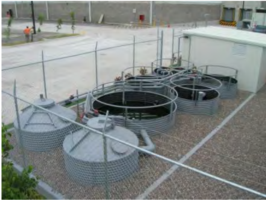
Figura 20. Fotografía de sistema Ecolo-System semi-enterrado
