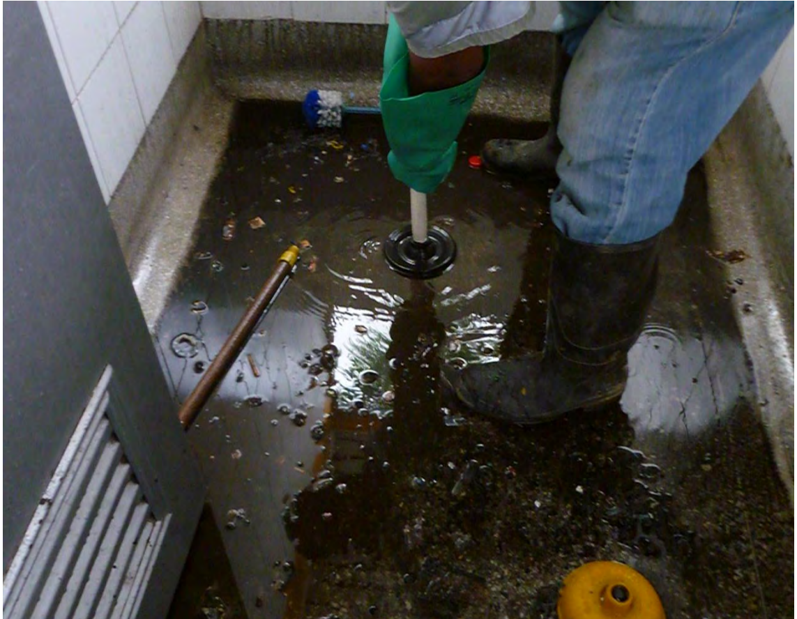
Figura 13. Fotografía de cañería obstruida en el área de abordajes
