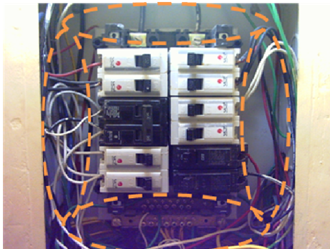
Figura 36. Caja de breakers destapada.
